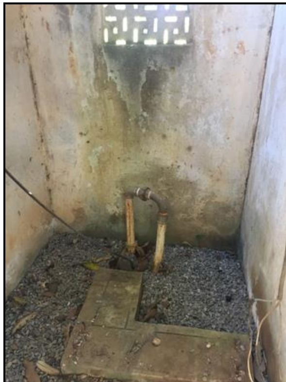
Figura 54 – Poço – Povoado Porto Santana Fonte: Premier Engenharia, 2018.
