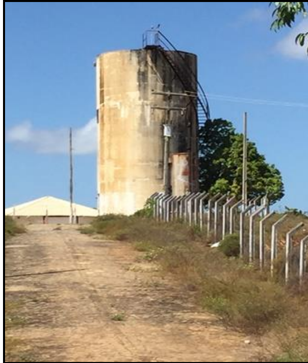
Figura 41 – Reservatório Elevado – Sistema Ponta dos Mangues Fonte: Premier Engenharia, 2018.
