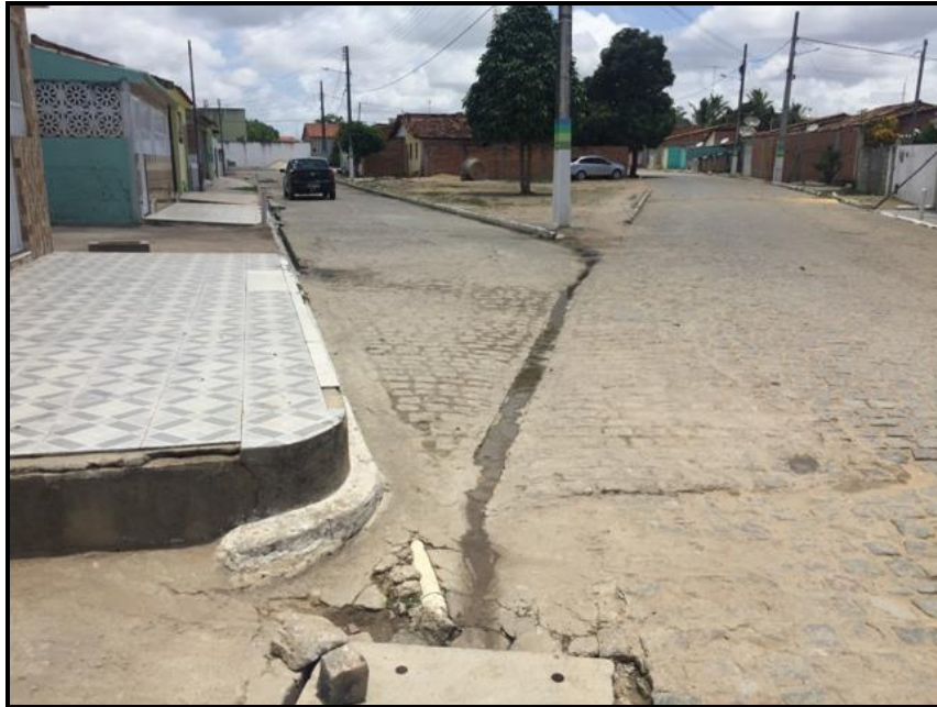
Figura 77 – Ponto de lançamento de esgoto localizado na Rua Antônio Travassos
