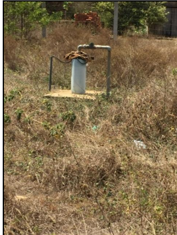
Figura 34 – Poço do Sistema 2 – Povoado Ponta dos Mangues Fonte: Premier Engenharia, 2018.
