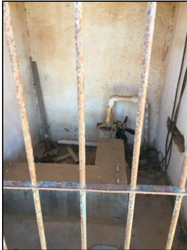
Figura 50 – Poço – Povoado Santana Fonte: Premier Engenharia, 2018.
