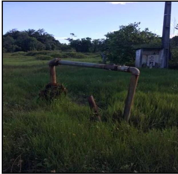
Figura 33 – Poço 2 do Sistema 1 – Abastecimento da Sede Fonte: Premier Engenharia, 2018.
