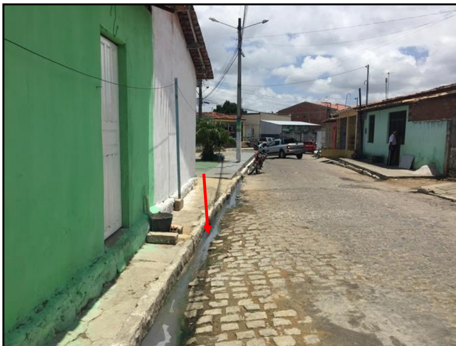
Figura 127 – Efluente de esgoto na via pública (Rua Antônio Travassos) Fonte: Premier Engenharia, 2018.
