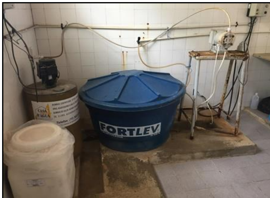
Figura 36 – Tratamento – Sistema 1 – Na Sede Urbana Fonte: Premier Engenharia, 2018.
