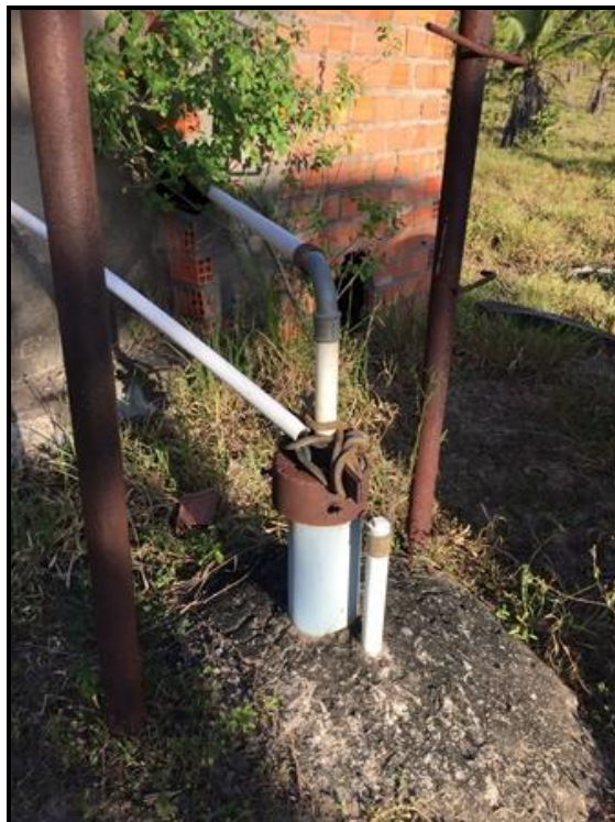
Figura 65 – Poço – Povoado Tabuleiro do Garcia Fonte: Premier Engenharia, 2018.
