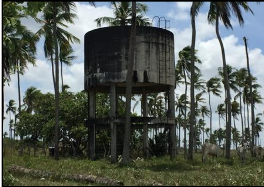
Figura 42 – Reservatório Elevado – Sistema Estiva do Raposo
