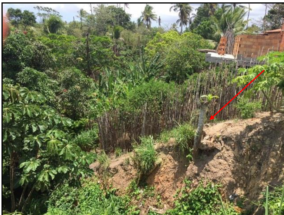
Figura 148 – Risco de deslizamento no Beco Mangabeira (vista 1) Fonte: Brasil / ANA, 2018.
