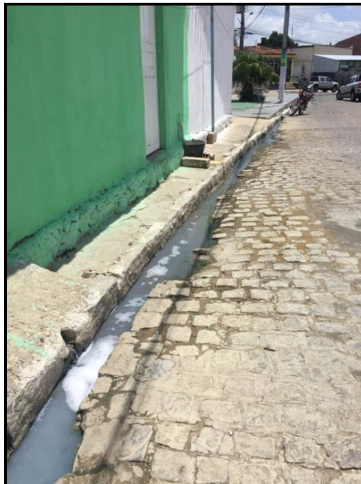
Figura 78 – Ponto de lançamento de esgoto a céu aberto localizado no início da Rua Antônio Travassos
