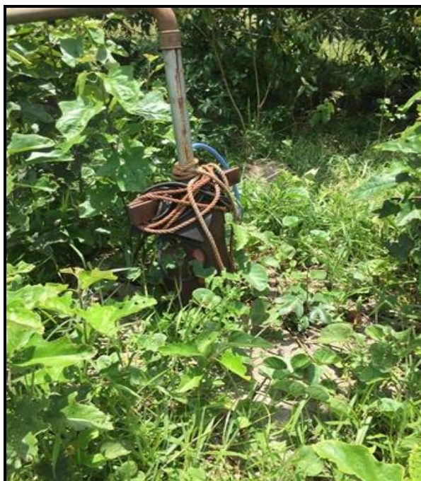
Figura 35 – Poço do Sistema 3 – Povoado Estiva do Raposo Fonte: Premier Engenharia, 2018.
