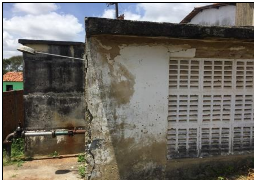
Figura 43 – Casa de Bombas – ERAT – Sistema 1 (vista externa) Fonte: Premier Engenharia, 2018.
