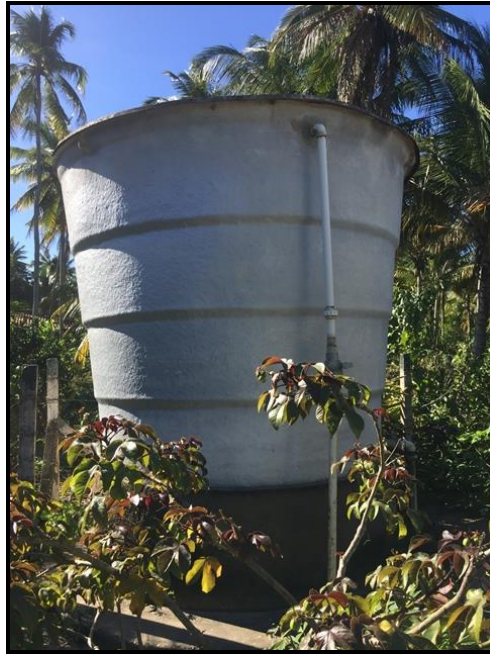
Figura 58 – Reservatório 2 – Povoado Geme Fonte: Premier Engenharia, 2018.
