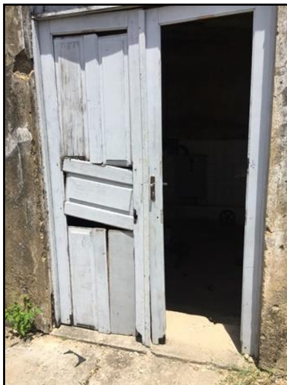
Figura 68 – Casa de Bombas – ERAT – Sistema 1 (DESO) Fonte: Premier Engenharia, 2018.
