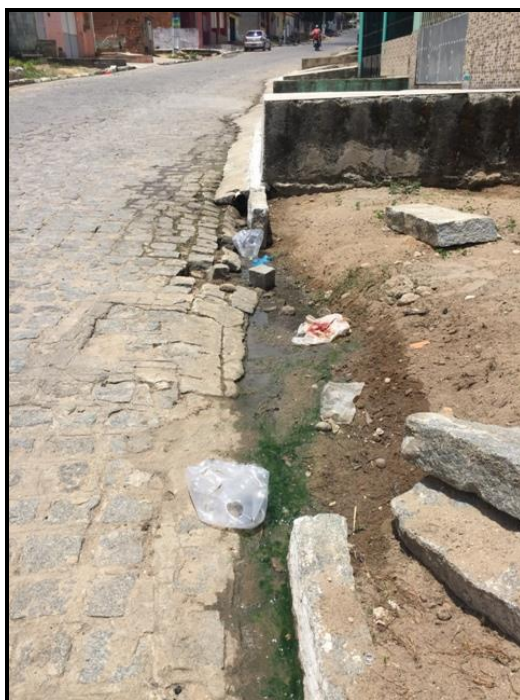
Figura 80 – Ponto de encontro do esgoto a céu aberto localizado na Rua João Batista de Melo
