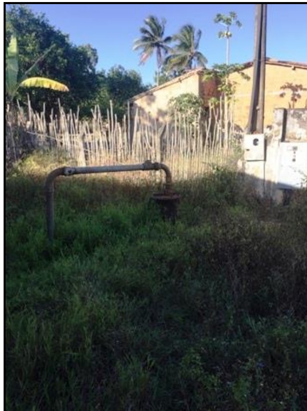
Figura 32 – Poço 1 do Sistema 1 – Abastecimento da Sede Fonte: Premier Engenharia, 2018.
