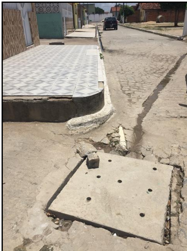
Figura 126 – Efluente de esgoto em direção ao coletor de água pluvial (Rua Antônio Travassos)
