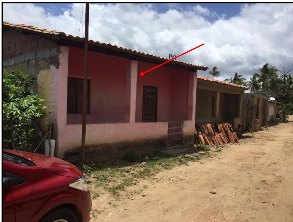
Figura 150 – Residência interditada no Beco Mangabeira Fonte: Brasil / ANA, 2018.
