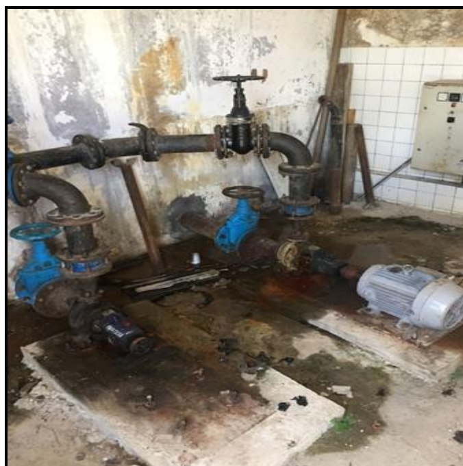
Figura 44 – Casa de Bombas – ERAT – Sistema 1 (vista interna) Fonte: Premier Engenharia, 2018.
