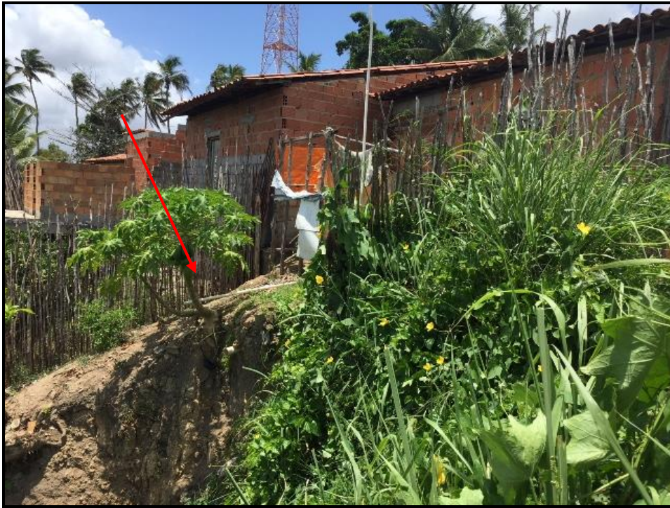
Figura 149 – Risco de deslizamento no Beco Mangabeira (10°27'08,77"S e 36°38'50,24"O vista 2) Fonte: Brasil / ANA, 2018.
