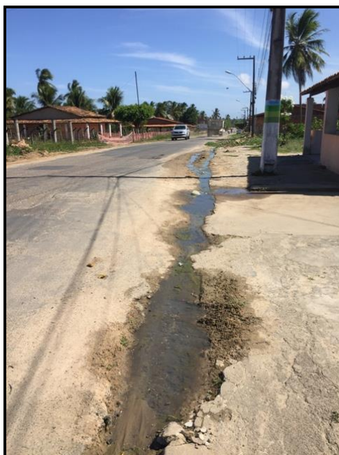
Figura 82 – Ponto de lançamento de esgoto a céu aberto localizado na Rod. José Machado Tojal Fonte – Premier Engenharia, 2018.
