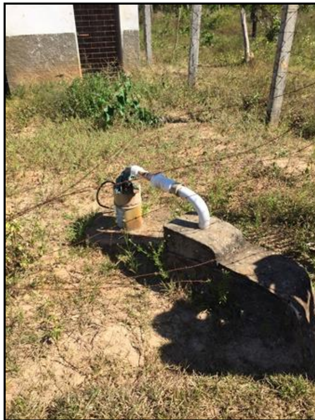
Figura 46 – Poço – Povoado Lagoa Grande Fonte: Premier Engenharia, 2018.
