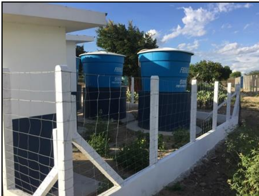
Figura 57 – Reservatórios do Sist. de Dessalinização Comun. Cajarana Fonte: Premier Engenharia, 2018
