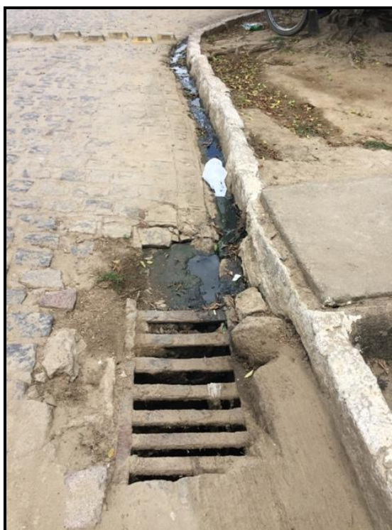
Figura 110 – Boca-de-lobo com grelha de concreto Fonte: Premier Engenharia, 2018.
