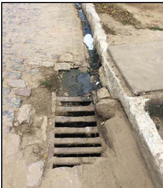
Figura 70 – Ponto de lançamento de esgoto a céu aberto localizado na Rua Sargento Benevides V. Monte Fonte – Premier Engenharia, 2018.
