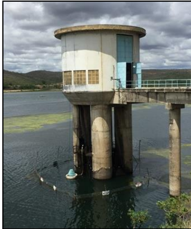
Figura 32 – Captação – Rio São Francisco Fonte: Premier Engenharia, 2018
