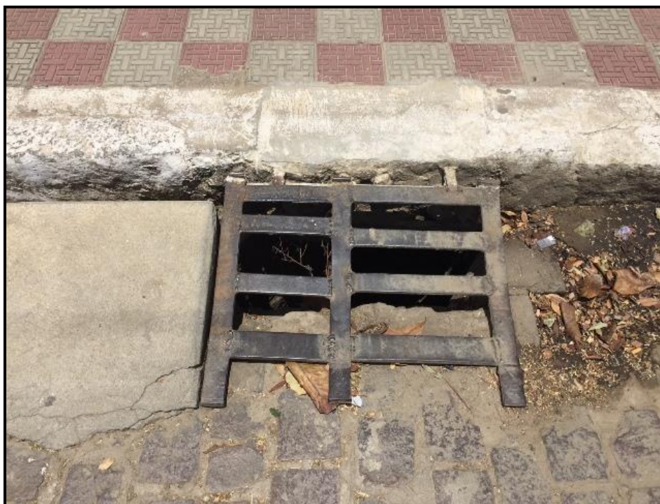
Figura 108 – Boca-de-lobo com greija de ferro (presença de lixo envolta) Fonte: Premier Engenharia, 2018.
