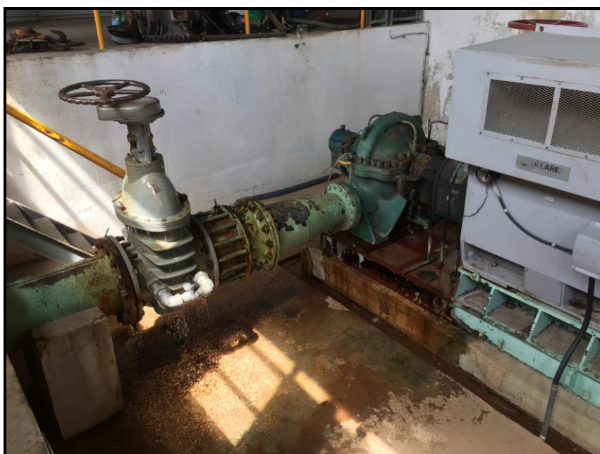
Figura 62 – Vazamento em Registro na ERAT1 Fonte: Premier Engenharia, 2018
