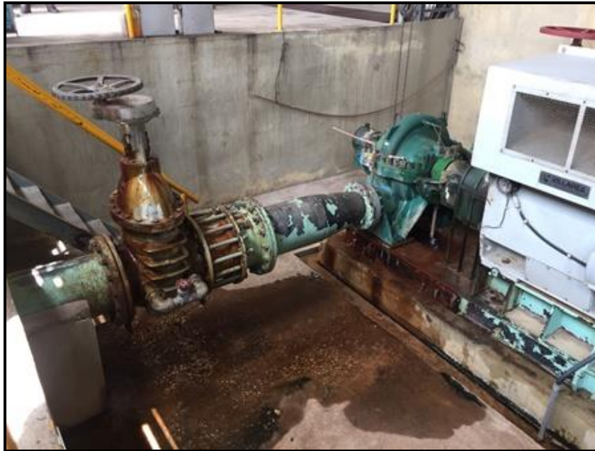
Figura 38 – Vazamento no registro ERAB-2 Fonte: Premier Engenharia, 2018
