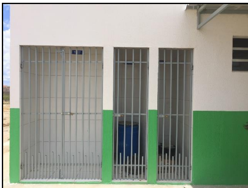
Figura 87 – Armazenamento de RSS da USF Dr. Getúlio Izidoro da Rocha Fonte: Premier Engenharia, 2018.
