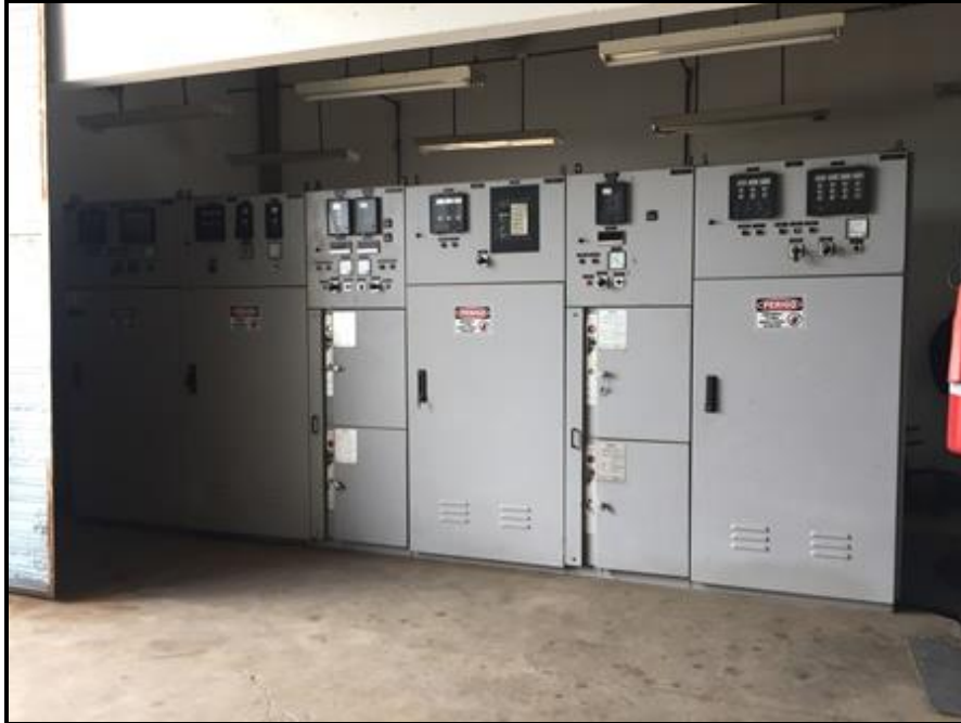
Figura 37 – Quadro de comando ERAB-2 Fonte: Premier Engenharia, 2018
