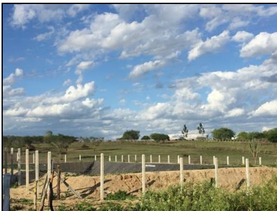
Figura 58 – Tanque – Sist. Dessalinização da Comunidade Cajarana Fonte: Premier Engenharia, 2018
