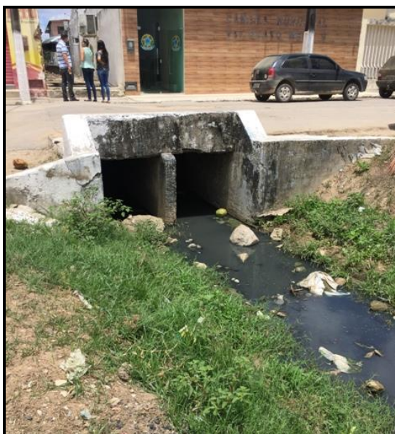
Figura 69 – Ponto de lançamento de esgoto a céu aberto localizado na Rua Sargento Benevides V. Monte Fonte – Premier Engenharia, 2018.
