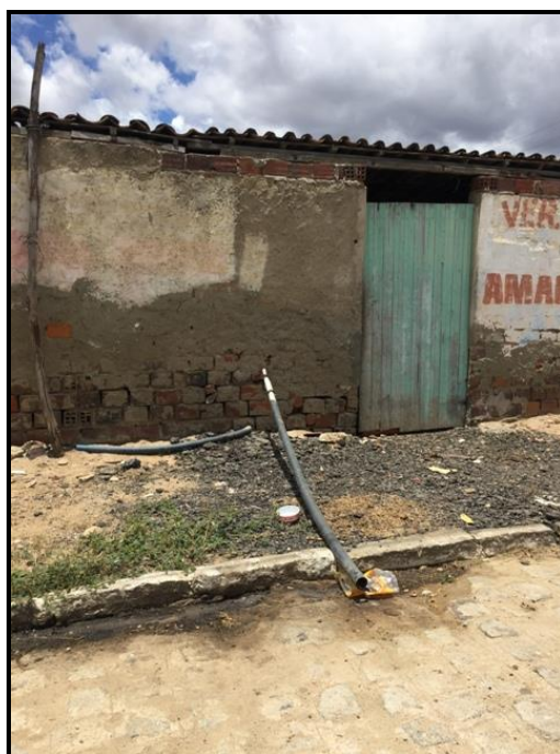
Figura 67 – Ponto de lançamento de esgoto a céu aberto localizado na Av. Vereador Paulo Leite Moraes Fonte – Premier Engenharia, 2018.
