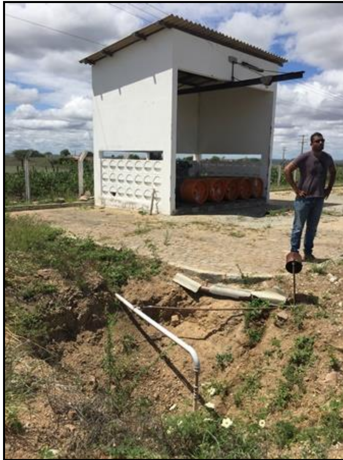
Figura 42 – Ponto de Dosagem de Cloro na Adutora Fonte: Premier Engenharia, 2018
