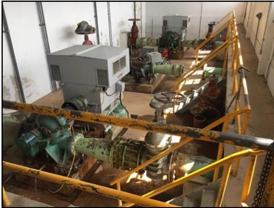
Figura 44 - Conjuntos motobombas ERAT-1 Fonte: Premier Engenharia, 2018
