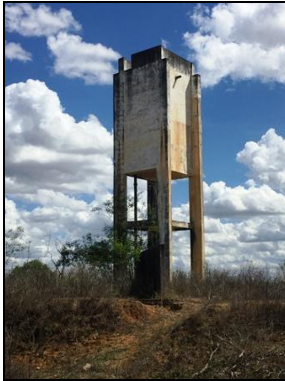
Figura 52 – Reservatório R-06 – Dist. de São Marcos Fonte: Premier Engenharia, 2018
