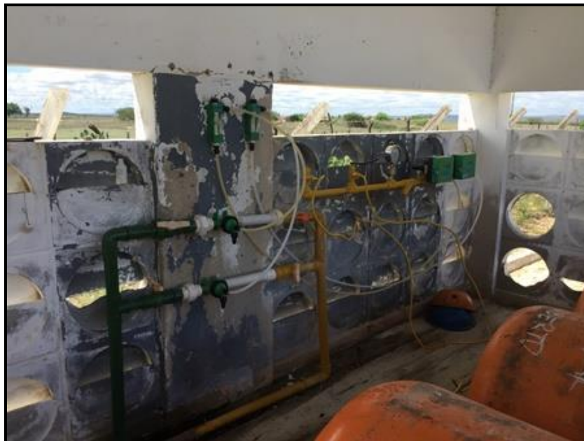
Figura 41 – Dosadores de Cloro Gasoso Fonte: Premier Engenharia, 2018
