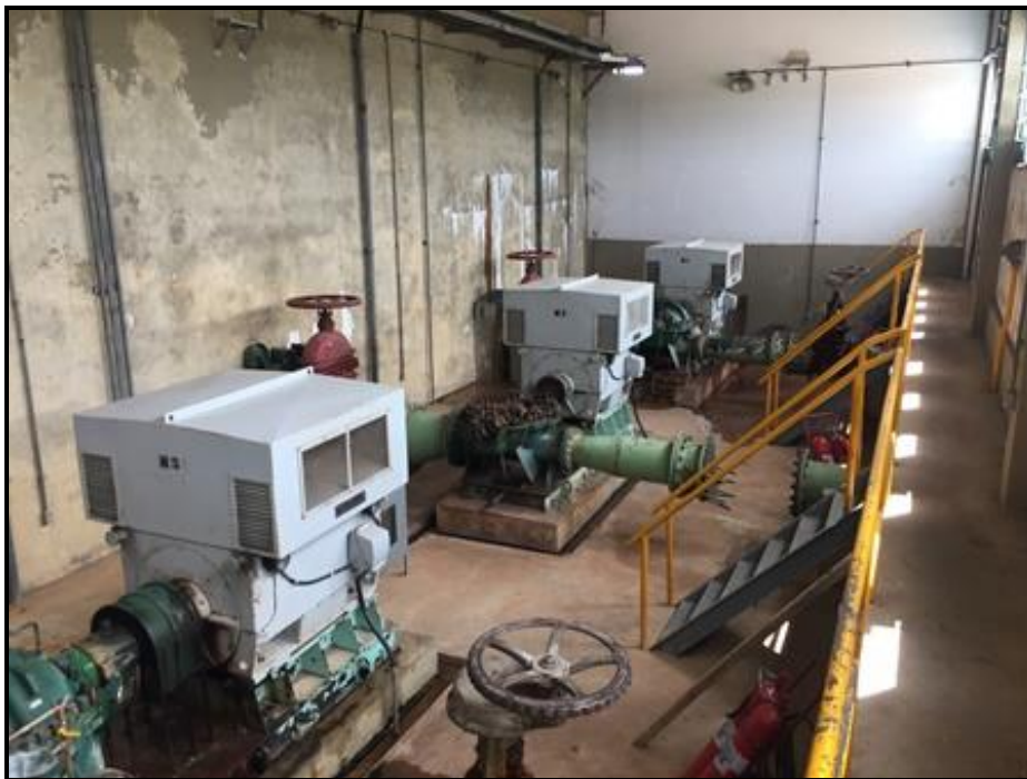
Figura 36 – Conjuntos motobombas ERAB-2 Fonte: Premier Engenharia, 2018
