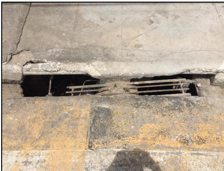
Figura 109 – Boca-de-lobo em mau estado de conservação Fonte: Premier Engenharia, 2018.
