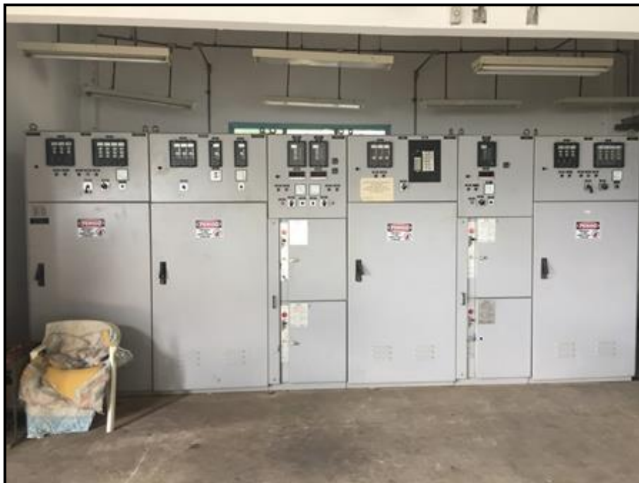
Figura 45 - Quadro de comando ERAT-1 Fonte: Premier Engenharia, 2018
