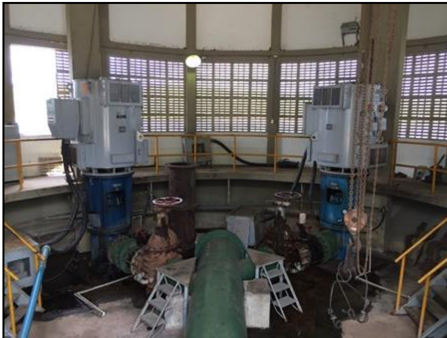
Figura 34 – Conjuntos Motobomba ERAB-1 Fonte: Premier Engenharia, 2018
