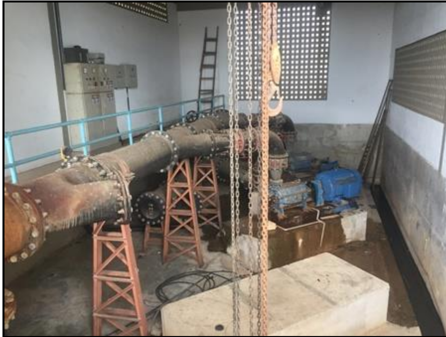
Figura 47 - Conjuntos motobombas ERAT-2 Fonte: Premier Engenharia, 2018
