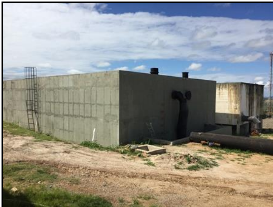
Figura 49 – Reservatórios R-01 e R-02 – Olho D'água das Flores Fonte: Premier Engenharia, 2018
