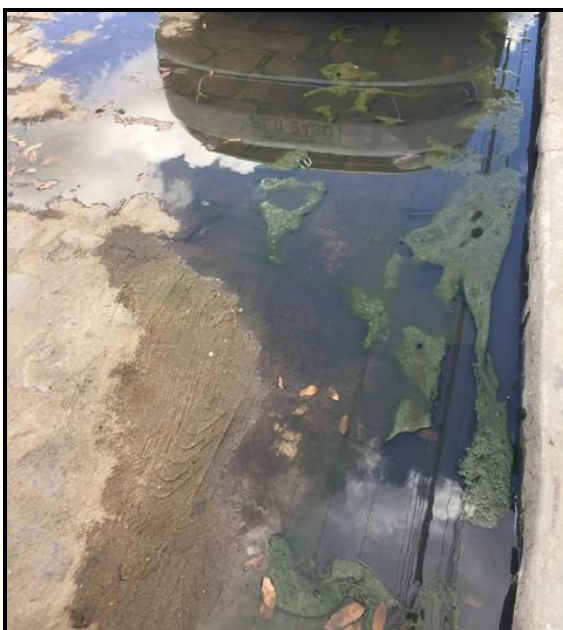
Figura 71 – Ponto de lançamento de esgoto a céu aberto localizado na Rua Sargento Benevides V. Monte Fonte – Premier Engenharia, 2018.
