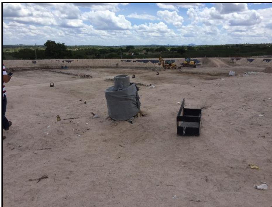
Figura 94 – Dreno de gás Fonte: Premier Engenharia, 2018.
