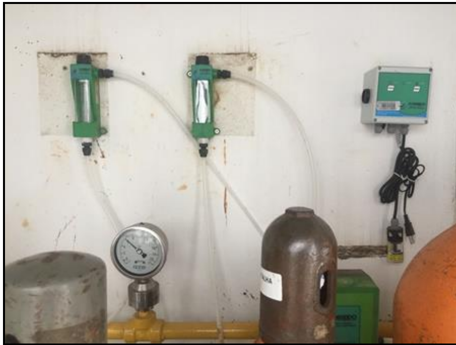
Figura 48 – Dosadores de Cloro – Município de Batalha Fonte: Premier Engenharia, 2018
