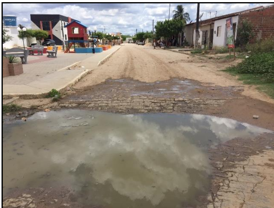
Figura 126 – Área Problema 4: acúmulo de água em decorrência do não escoamento
