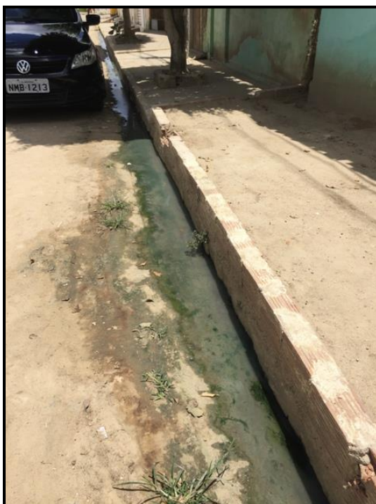
Figura 66 – Ponto de lançamento de esgoto a céu aberto localizado na Av. Vereador Paulo Leite Moraes Fonte – Premier Engenharia, 2018.
