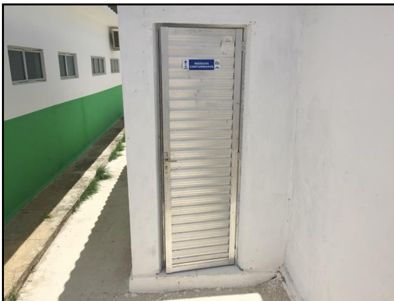
Figura 86 – Local de armazenamento de RSS da USF Dr. João Rocha Fonte: Premier Engenharia, 2018.
