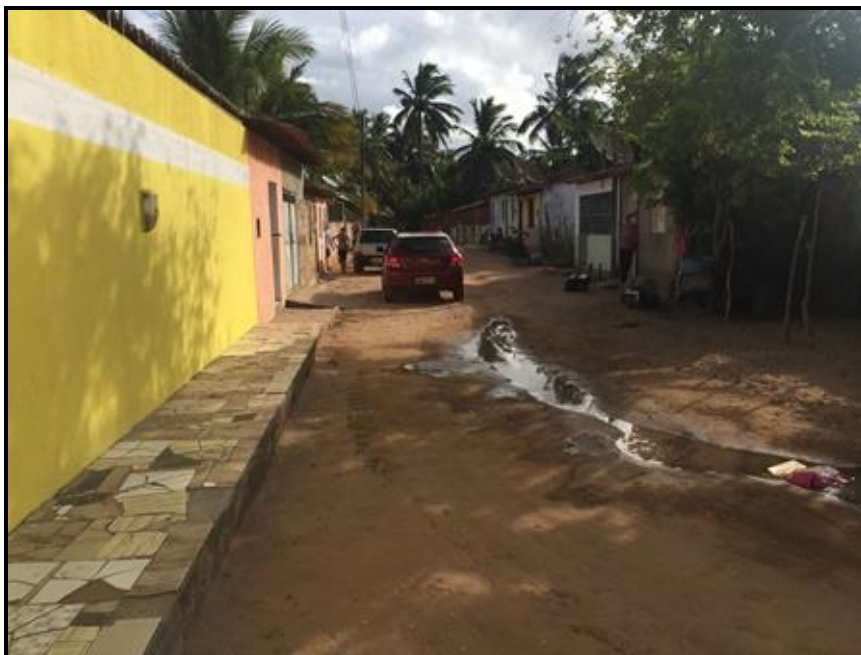
Figura 108 – Área Problema 7: inexistência de drenagem no local (vista 2) Fonte: Premier Engenharia, 2018.
