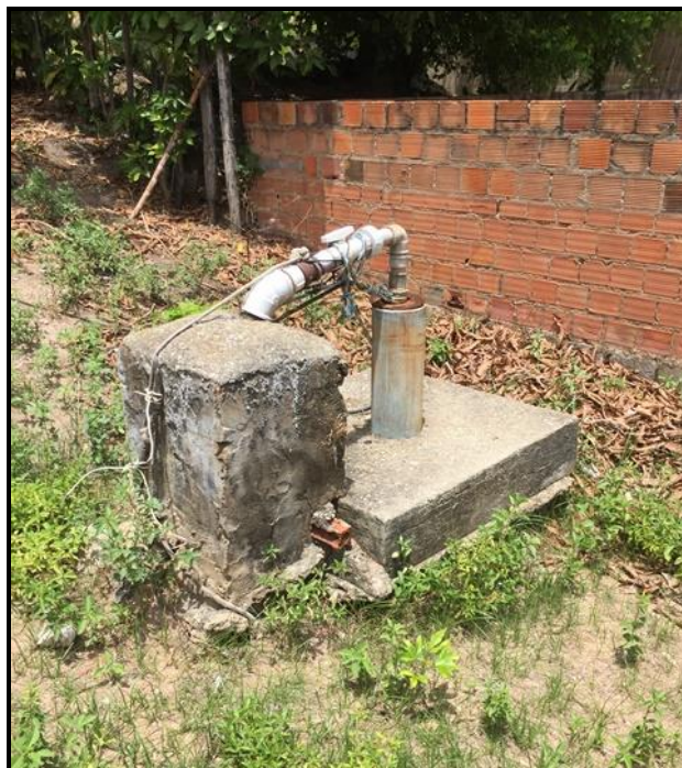
Figura 47 - Poço Povoado Flexeiras I Fonte – Premier Engenharia, 2018.
