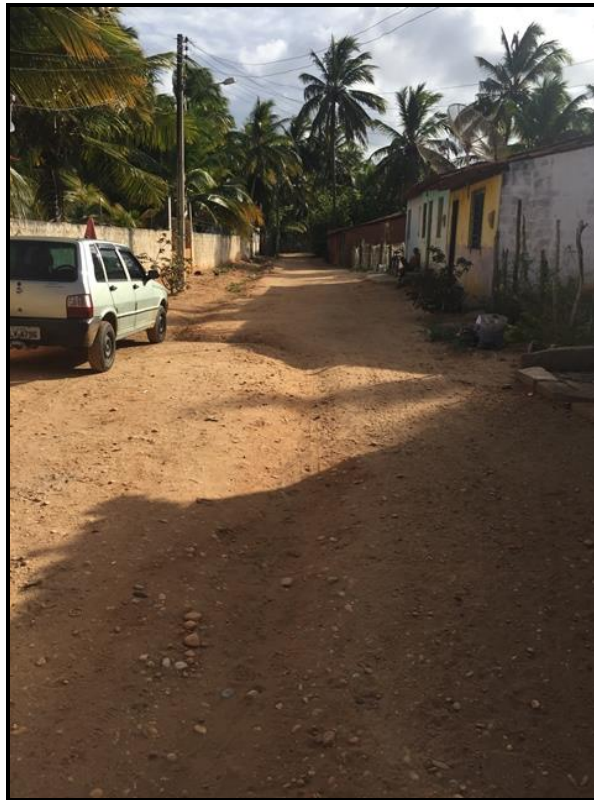
Figura 107 – Área Problema 7: inexistência de drenagem no local (vista 1) Fonte: Premier Engenharia, 2018.
