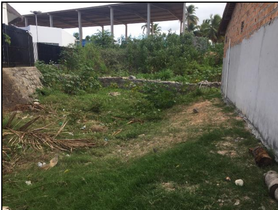
Figura 104 – Área Problema 5: terreno particular afetado pela falta de drenagem Fonte: Premier Engenharia, 2018.
