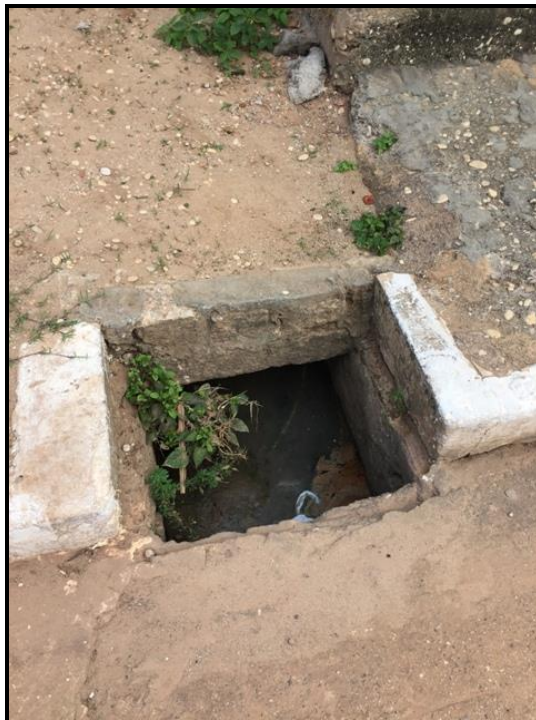
Figura 53 – Ponto de encontro do esgoto a céu aberto com a rede de drenagem localizado na Rua Dr. Getulio Vargas
