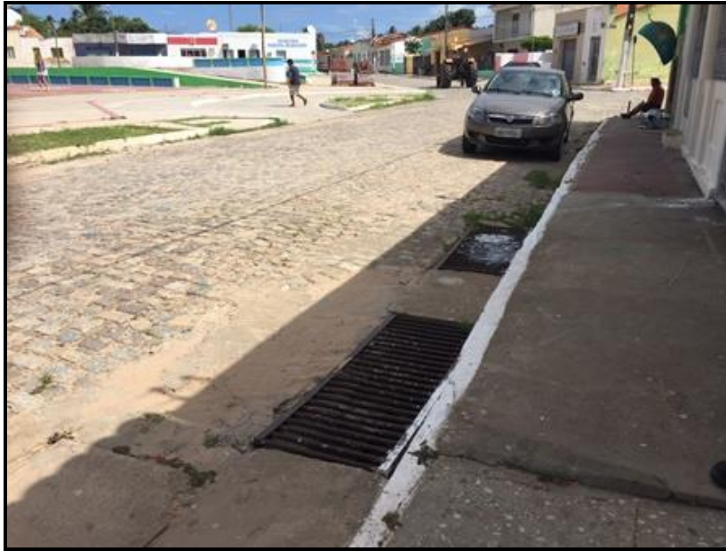
Figura 95 – Área Problema 1: região afetada por alagamento Fonte: Premier Engenharia, 2018.
