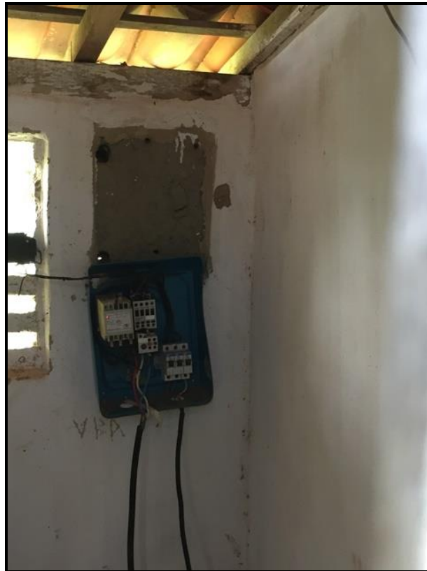
Figura 35 – Dispositivo de acionamento do poço Domingos Mendes II Fonte – Premier Engenharia, 2018.
