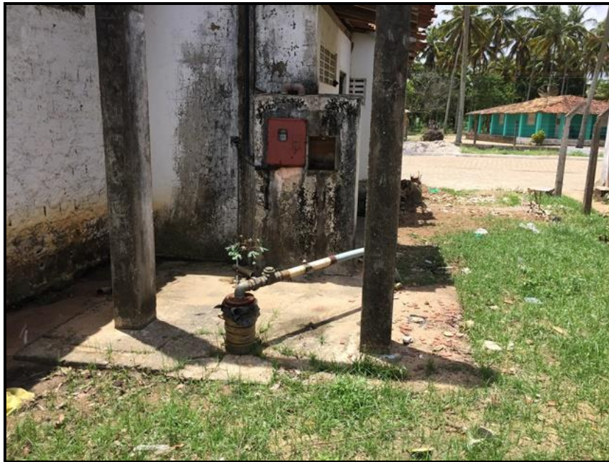
Figura 44 – Poço Povoado Pontes Fonte – Premier Engenharia, 2018.
