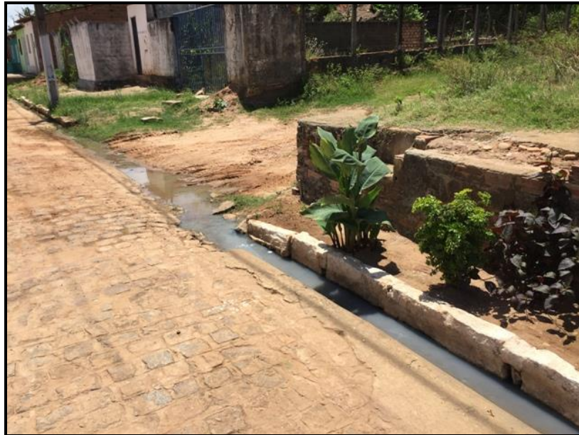
Figura 52 – Ponto de lançamento de esgoto a céu aberto localizado na Rua Dr. Getulio Vargas
