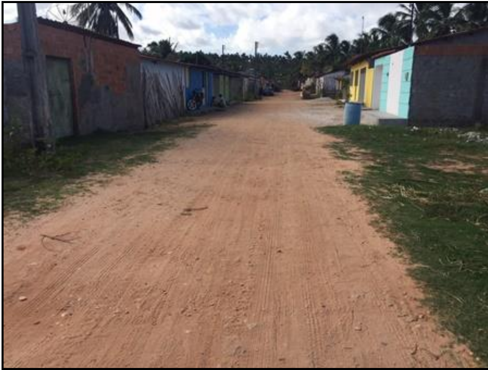
Figura 106 – Área Problema 6: inexistência de drenagem na localidade (vista com sentido para comunidade) Fonte: Premier Engenharia, 2018.
