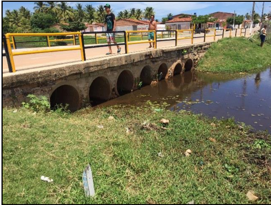
Figura 99 – Área Problema 3: ponte afetada pelo alagamento Fonte: Premier Engenharia, 2018.
