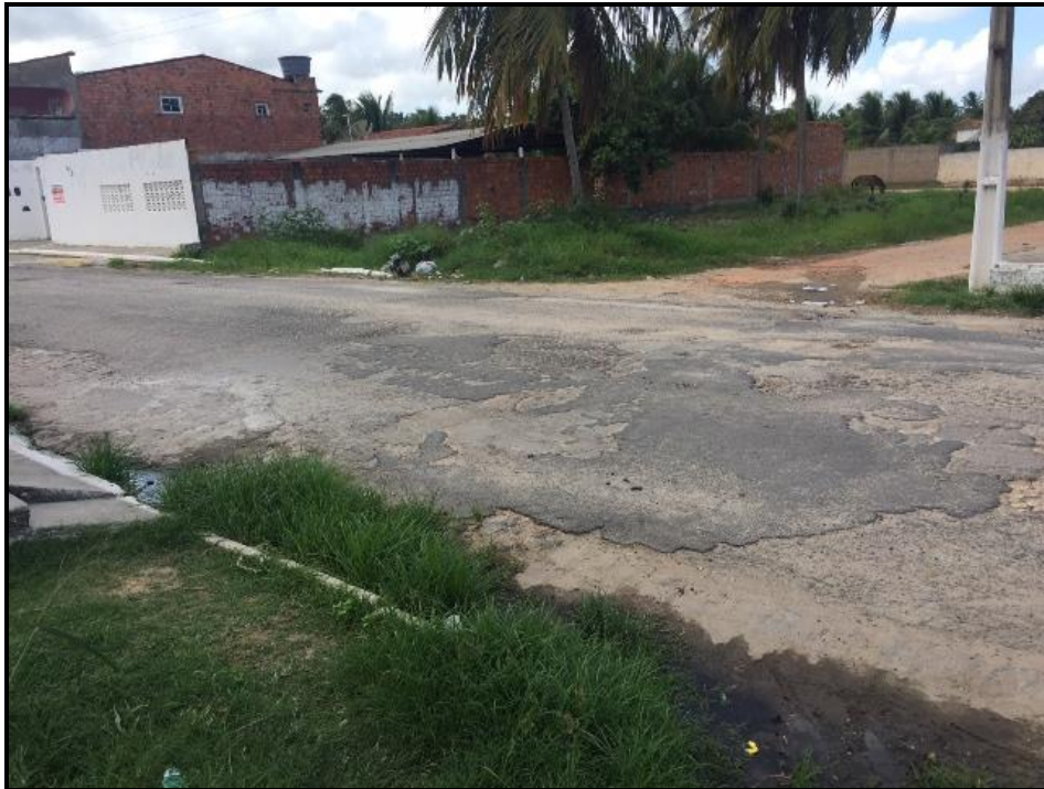
Figura 103 – Área Problema 5: inexistência de drenagem no local Fonte: Premier Engenharia, 2018.
