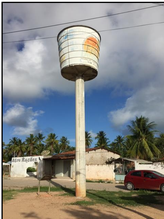
Figura 40 – Reservatório Elevado (R3) – Conj. Hab. Mãe do Homens Fonte – Premier Engenharia, 2018.
