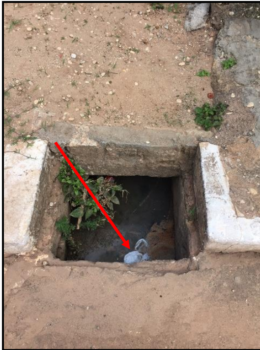
Figura 93 – Presença de lixo e despejo doméstico no dispositivo de captação de água pluvial Fonte: Premier Engenharia, 2018.
