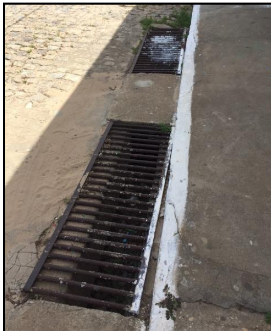
Figura 96 – Área Problema 1: detalhe das grelhas Fonte: Premier Engenharia, 2018.
