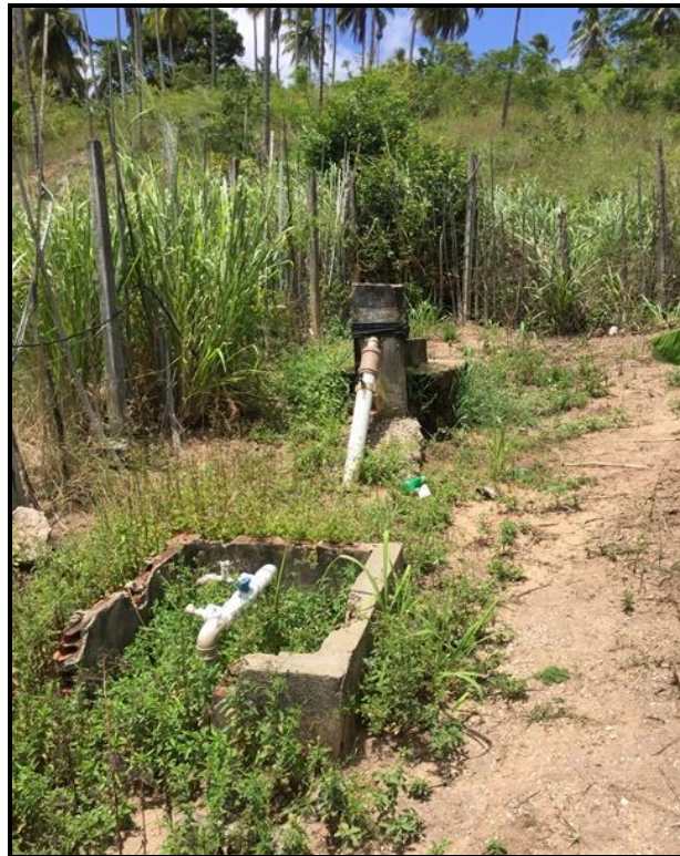
Figura 46 – Poço Povoado Flexeiras I Fonte – Premier Engenharia, 2018.
