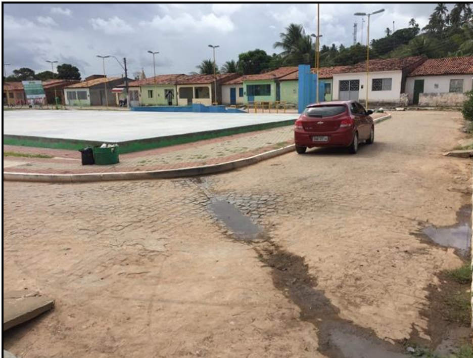
Figura 101 – Área Problema 4: inexistência de drenagem no local Fonte: Premier Engenharia, 2018.
