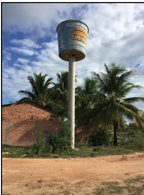
Figura 41 - Reservatório Elevado (R4) – Localidade do Areião Fonte – Premier Engenharia, 2018.
