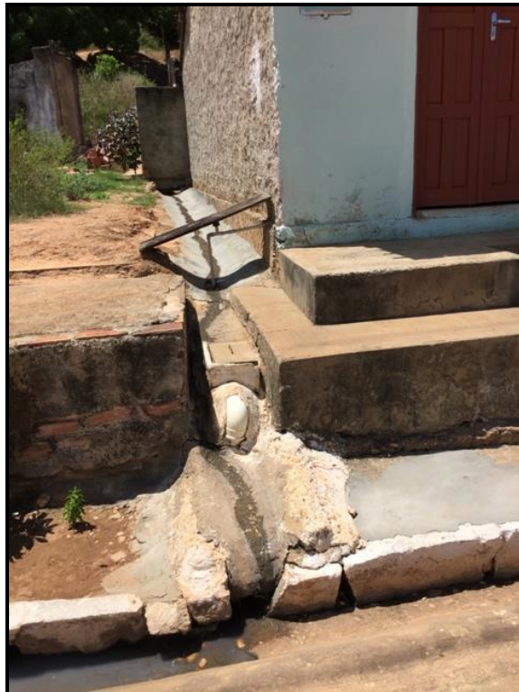
Figura 51 – Ponto de lançamento de esgoto a céu aberto localizado na Rua Dr. Getulio Vargas
