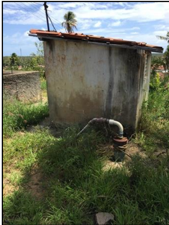
Figura 33 –Poço Domingos Mende III Fonte – Premier Engenharia, 2018.
