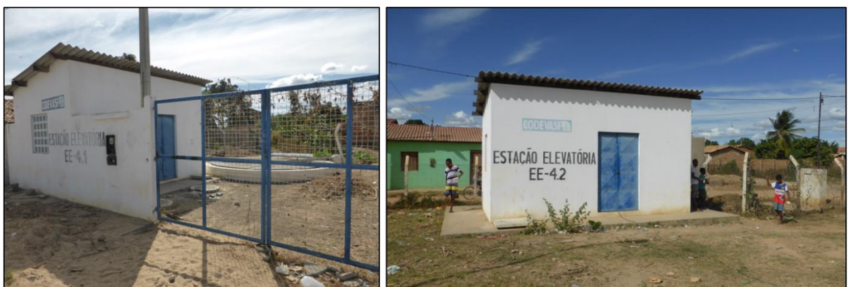
Fonte: ÁGUA E SOLO (2015) Figura 8.17 – EE com portão danificado que permitem a entrada de pessoas no local: EE.4.1 e EE.4.2
