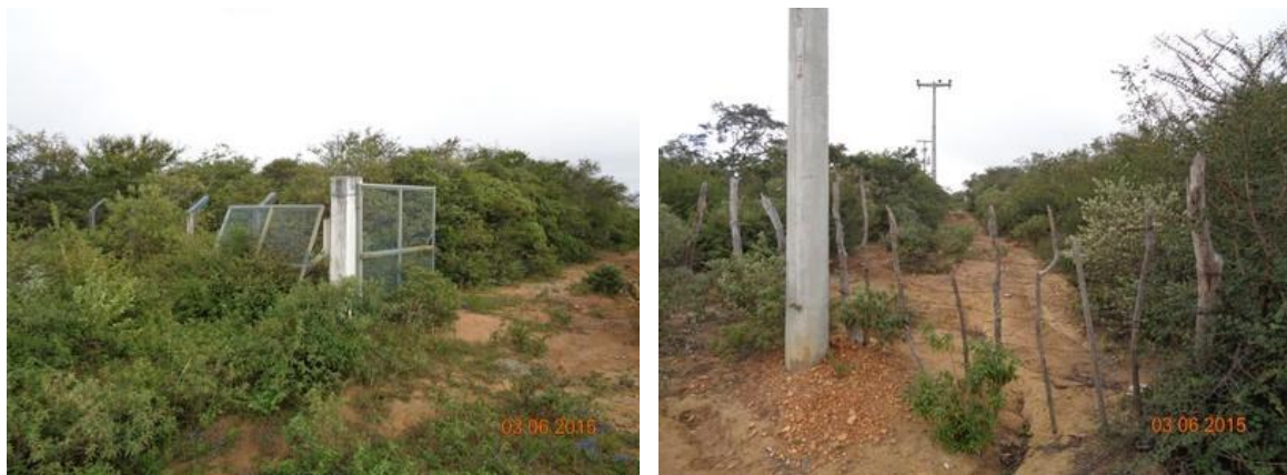
Figura 33 – Acesso a EEAB 1 – detalhe para o portão danificado e a falta de sinalização
