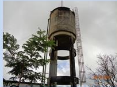
REL – capacidade de 70 m 3
