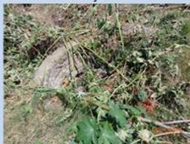
Poços de visita com estrutura danificada
