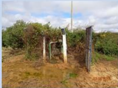
Poço 1 apresentando vazamento e tomado por vegetação
