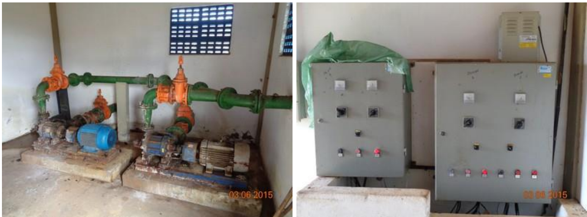
Figura 35 – EEAB 2 – vista do conjunto de bombas e painel de comando
