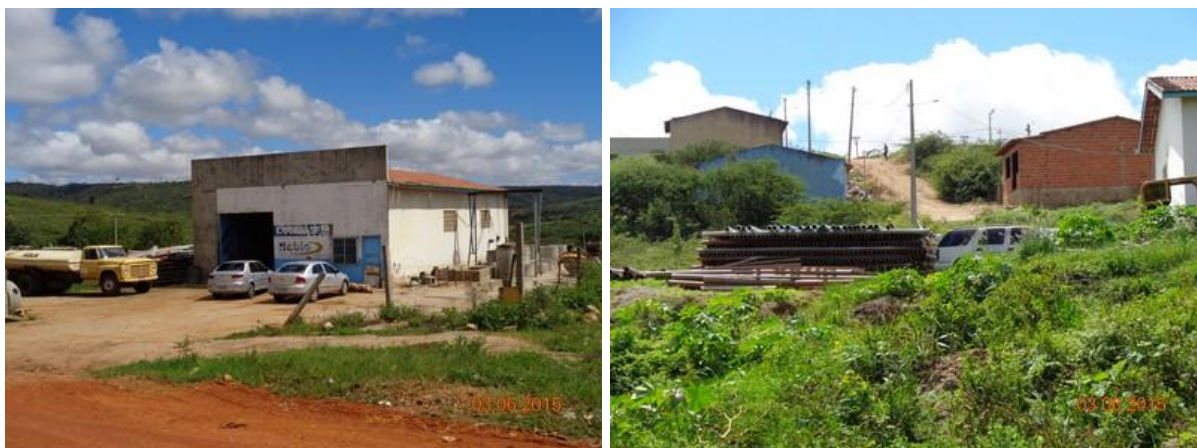
Figura 91 – Canteiro de obras da empresa que está executando a obra do SES
