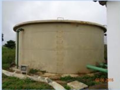
RAP – capacidade de 150 m 3
