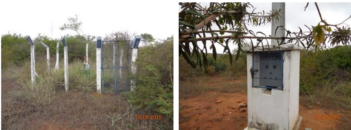
Figura 30 – Poço 2 tomado por vegetação e vista da caixa de força
