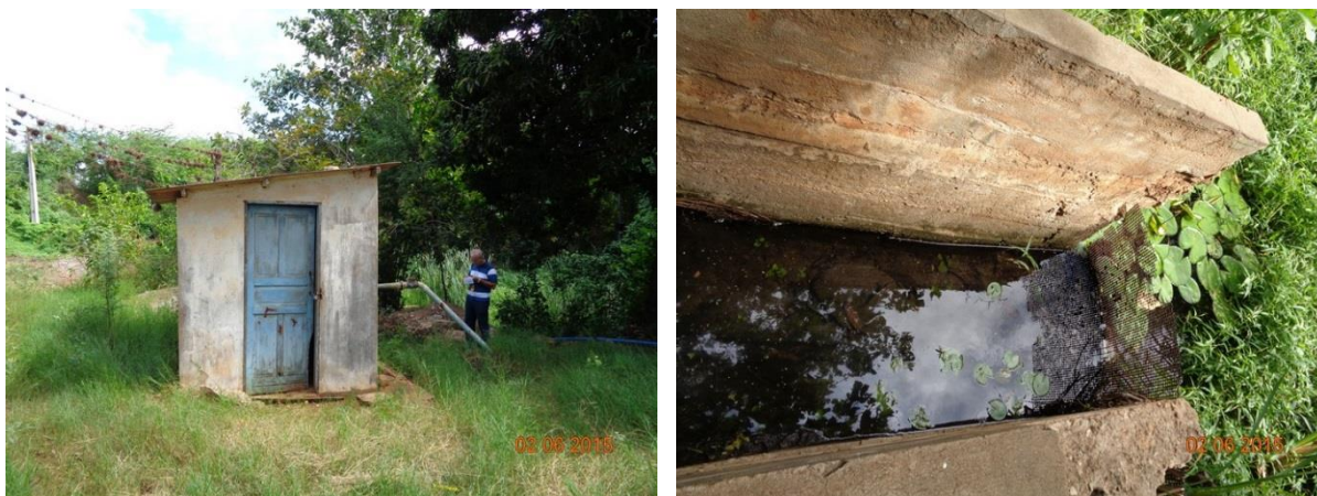
Figura 39 – Captação superficial no Rio Branco
