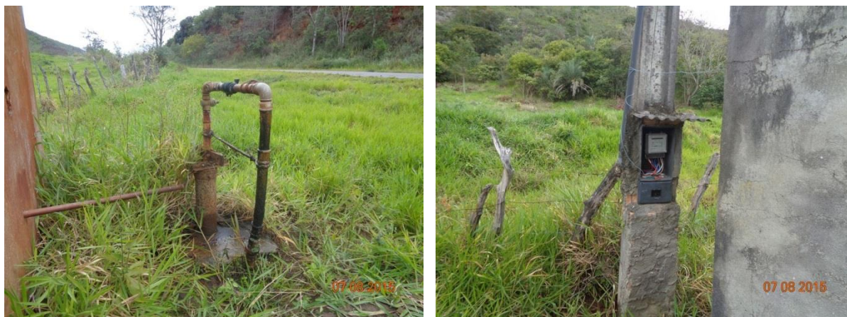
Figura 61 – Poço tubular profundo - povoado de Campo Grande
