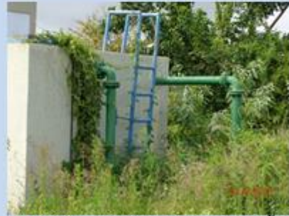
EEAB 2 – detalhe para a vegetação invadindo a área do prédio
