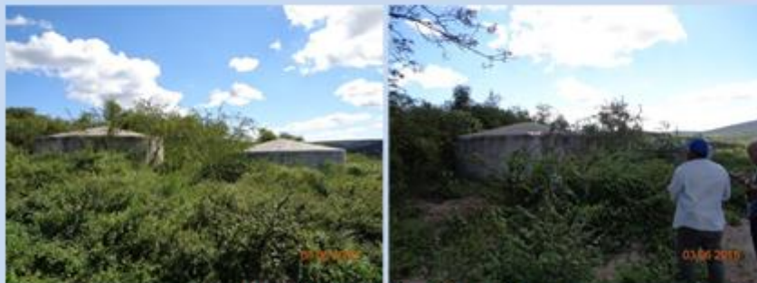
Reservatórios de 200 m 3 fora de uso
