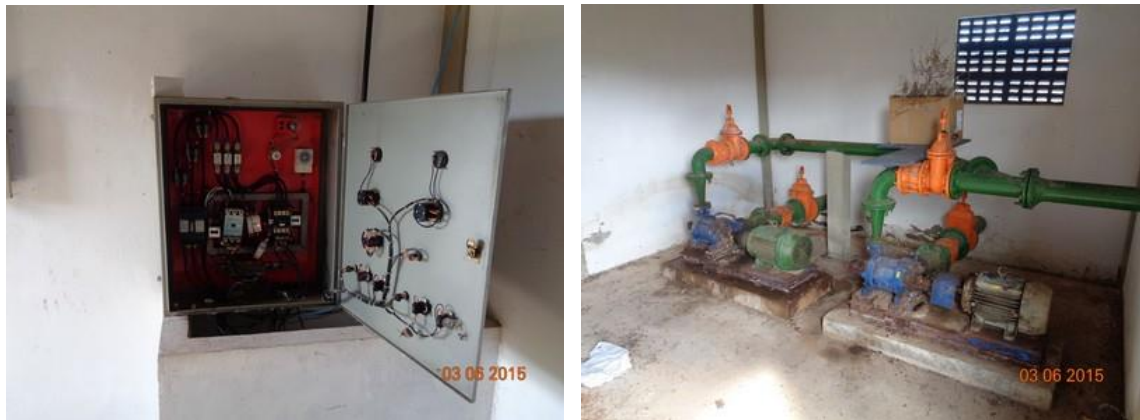
Figura 32 – Painel de comando e conjunto de bombas da EEAB 1
