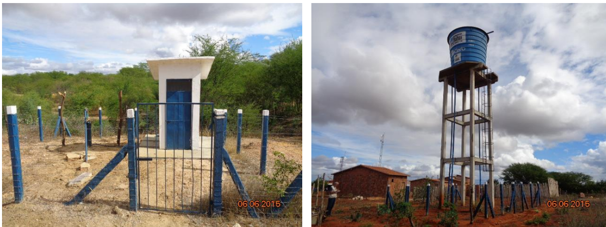
Figura 59 – Poço tubular profundo e o REL do povoado de Sussuarana
