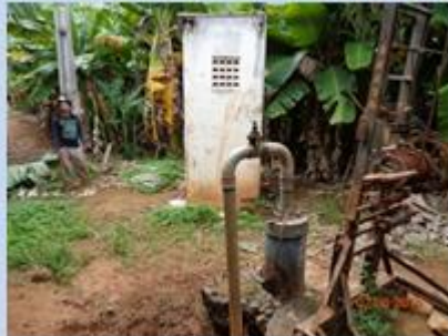
Poço tubular profundo
