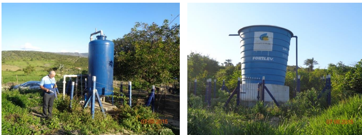
Figura 82 – Sistema de tratamento e reservação
