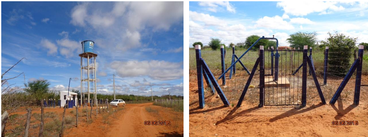
Figura 49 – REL e poço artesiano perfurado pela CERB no povoado de Lagoa da Canabrava
