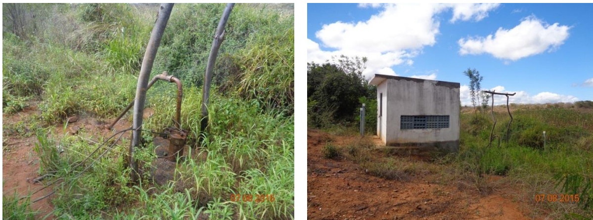
Figura 68 – Poço tubular profundo
