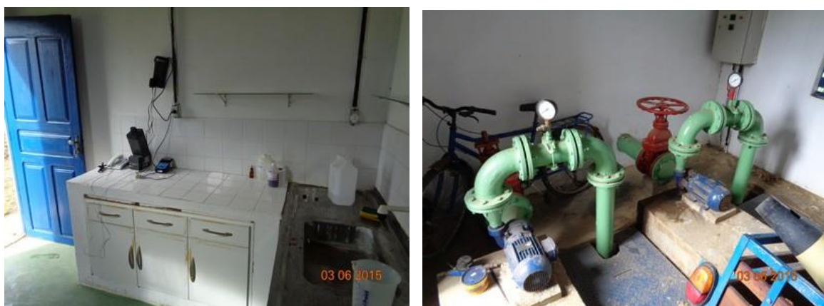
Figura 37 – Laboratório e casa de bombas da ETA Mirangaba
