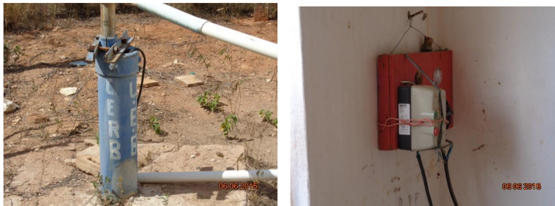
Figura 53 – Poço e painel de comando
