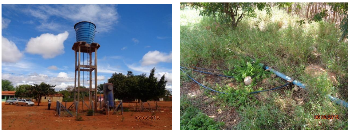
Figura 52 – Reservatório e rede de adução do poço para o reservatório
