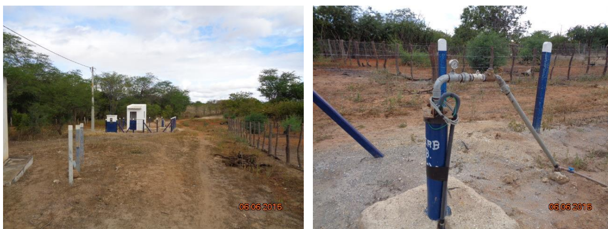
Figura 55 – Poço tubular profundo
