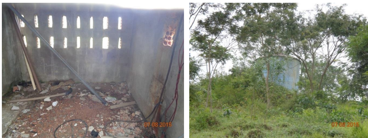
Figura 62 – Interior da cabine do painel do poço e reservatório
