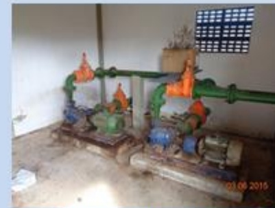
conjunto de bombas da EEAB 1
