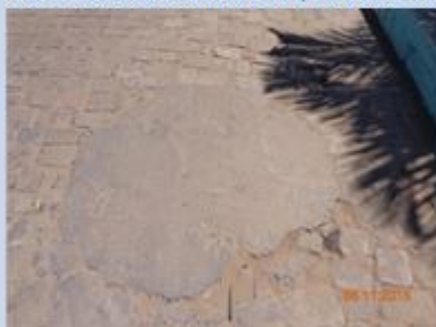
Poços de visita com a tampa coberta por concreto
