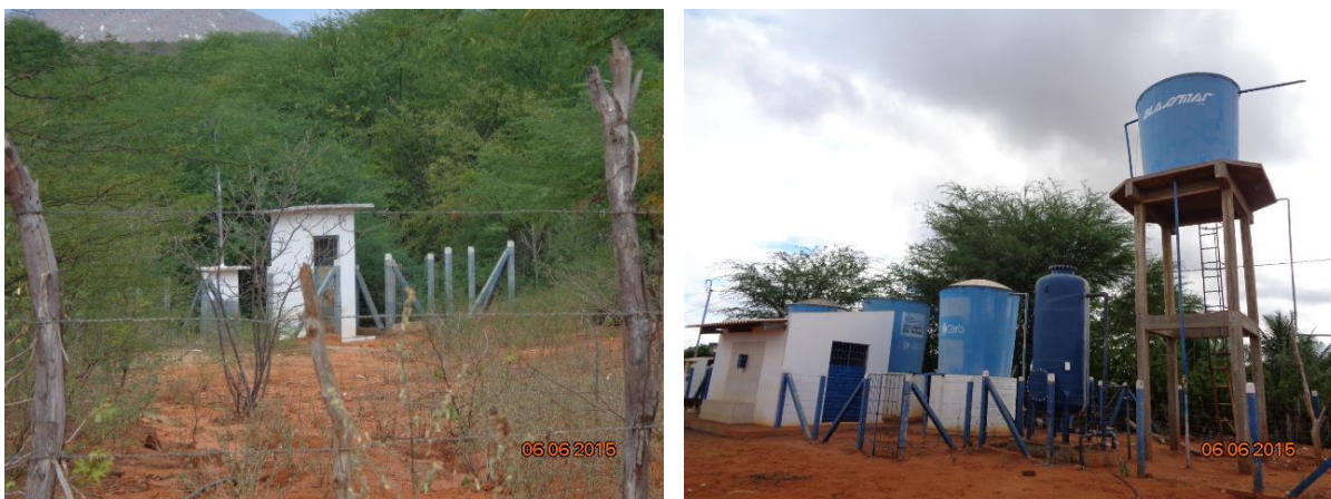
Figura 60 – Poço tubular profundo e o SAA do povoado de Pedra Vermelha
