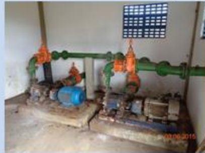
EEAB 2 – vista do conjunto de bombas
