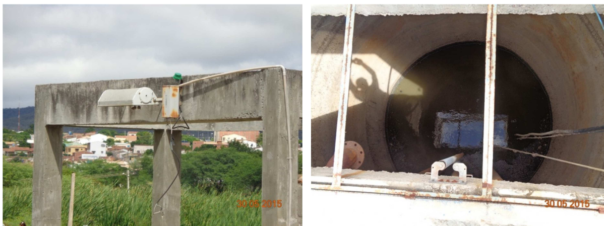
Figura 93 – Iluminação noturna e poços sem tampa
