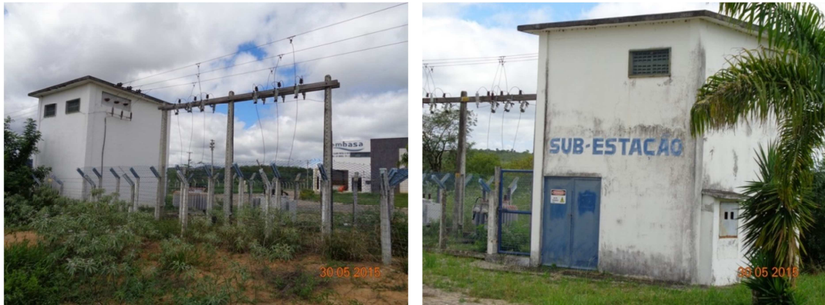
Figura 45 – ETA do França – Subestação
