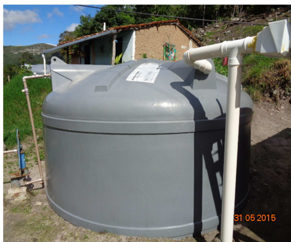
Figura 72 – imóveis com cisternas de 16 m 3
