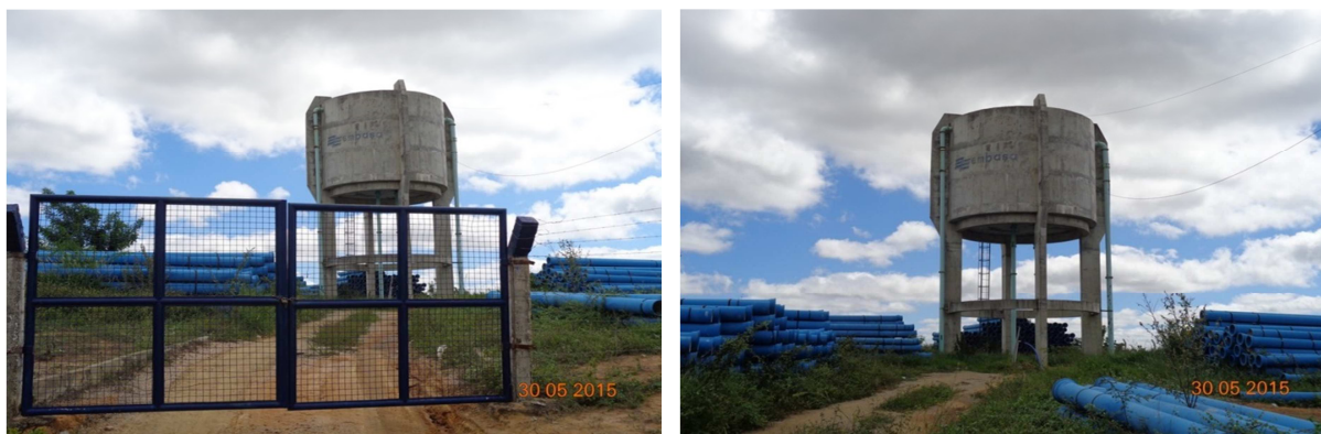
Figura 48 – REL elevado que abastece a parte alta de Miguel Calmon
