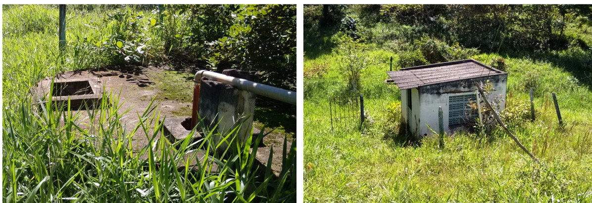
Figura 68 – Local de captação e casa de bombas em funcionamento
