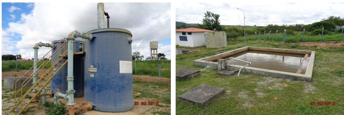
Figura 56 – Unidades de tratamento
