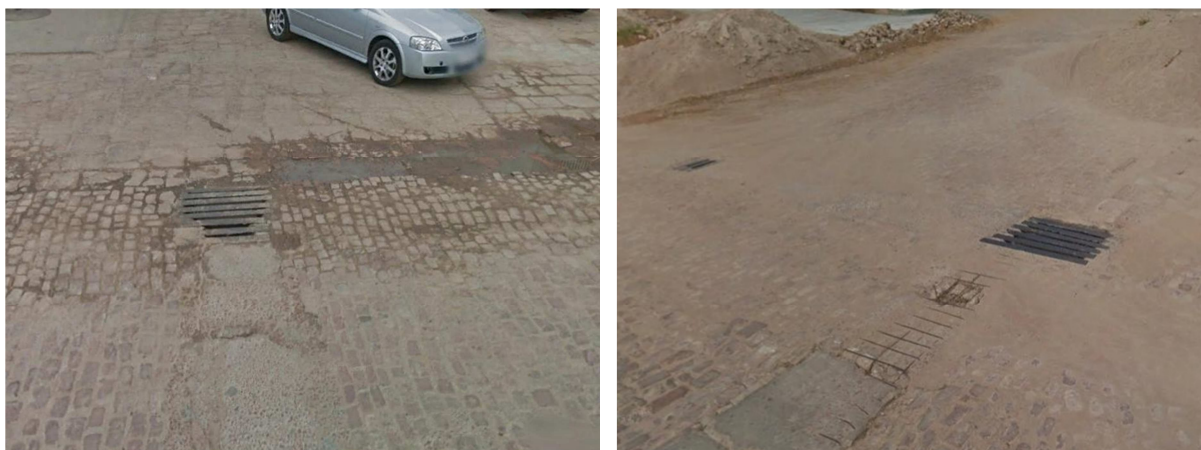
Figura 115 – Bocas de lobo em frente ao posto de gasolina
