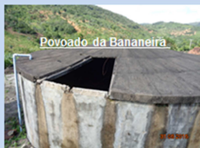
RAP de 20m 3 com danos na estrutura
