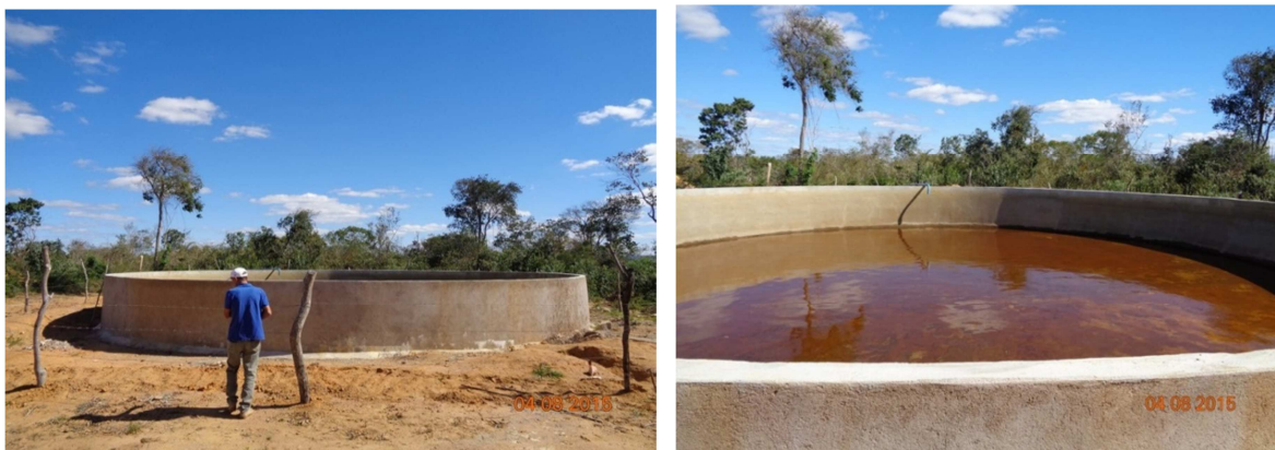
Figura 81 – Reservatório de 200 m 3 Vazio
