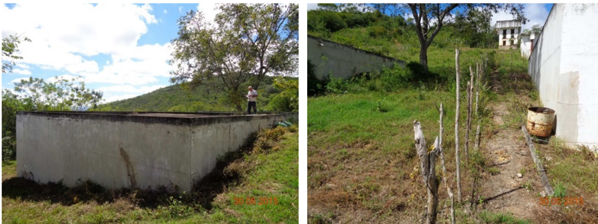
Figura 51 – Reservatório sem parapeito e cerca do perímetro de proteção de galhos secos da vegetação local
