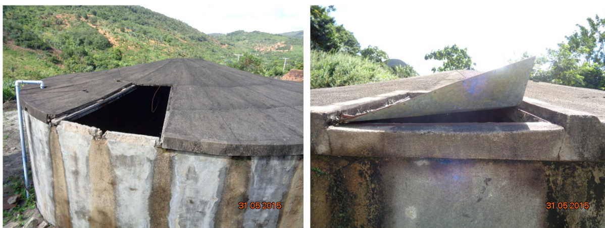
Figura 71 – RAP de 20m 3 com danos na estrutura
