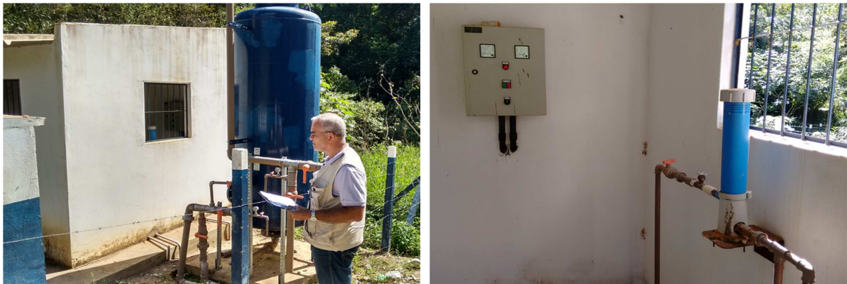
Figura 67 – Sistema construído pela CERB que está parado
