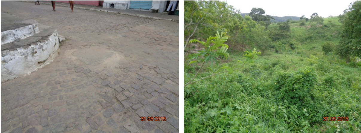
Figura 101 – PV com tampa de concreto e local onde é lançado o esgoto sem tratamento
