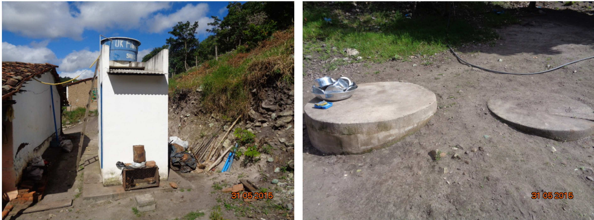
Figura 102 – Banheiro padrão FUNASA (à esquerda) e fossa séptica e sumidouro (à direita) no Povoado da Bananeira
