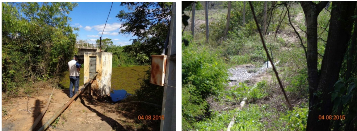
Figura 80 – Local da captação e rede para adução com furo
