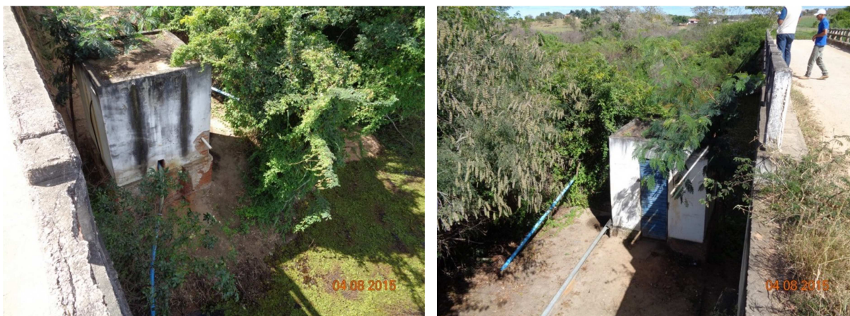
Figura 78 – Captação para os dois reservatórios de 25 m 3 e 50 m 3
