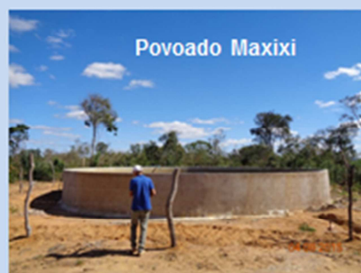
Reservatório sem tampa
