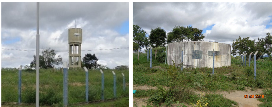
Figura 58 – REL elevado de 50 m 3 e RAP de 100 m 3
