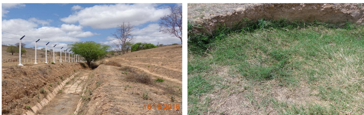
Figura 99 – Canaleta na parte externa da lagoa para águas pluviais e sinais de erosão com vazamento da lagoa
