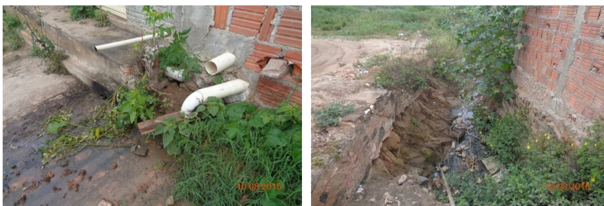
Figura 87 – Esgoto correndo as margens da Rua da Pedreira
