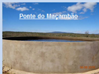
Reservatório sem tampa
