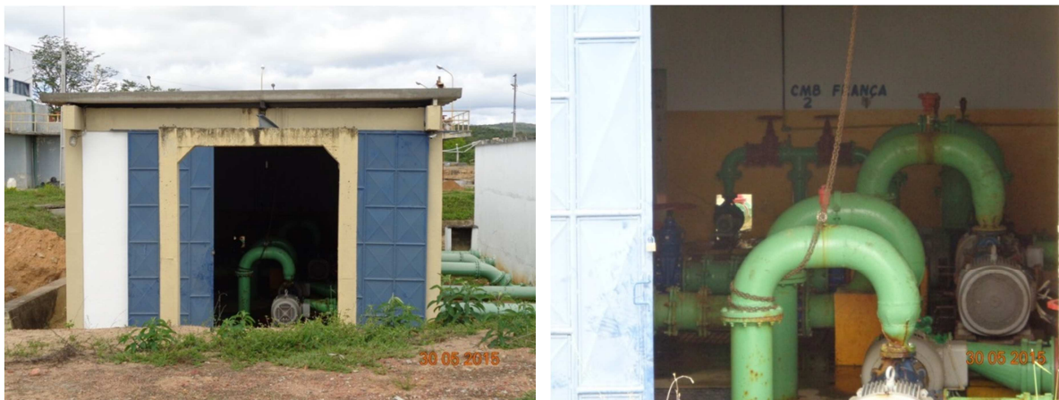
Figura 46 – ETA do França – casa de bombas
