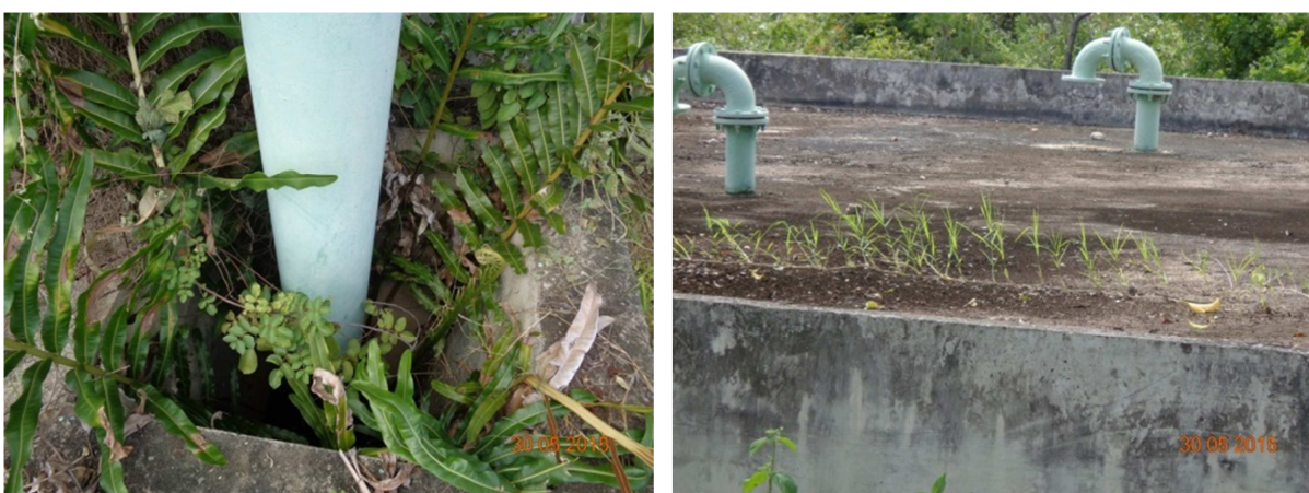
Figura 52 – Vegetação proliferando junto com as tubulações e sobre o terraço dos reservatórios
