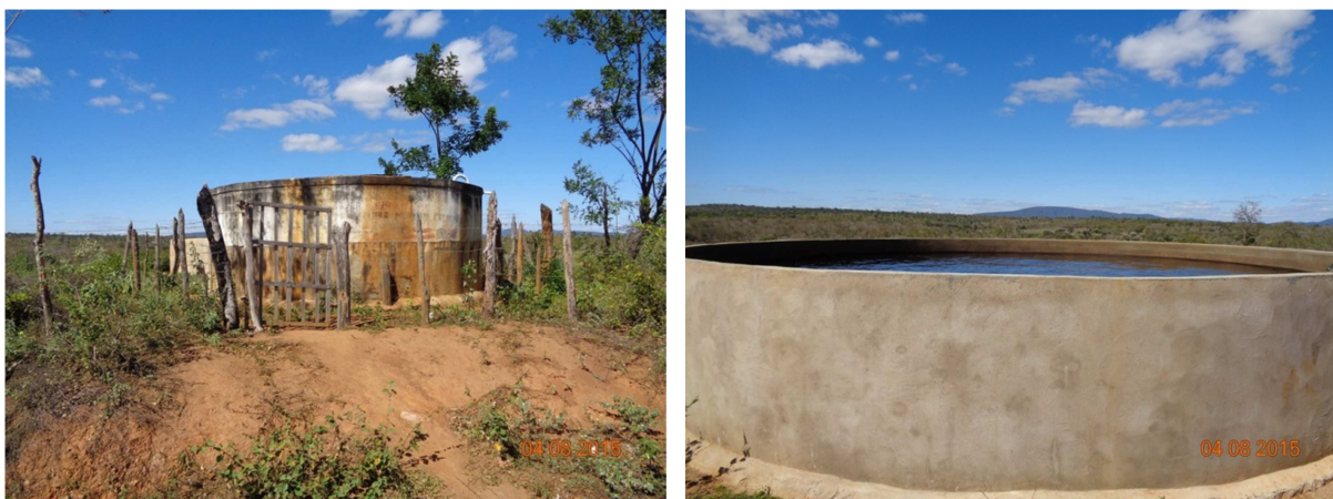
Figura 79 – Reservatórios de 25 m 3 e 50 m 3
