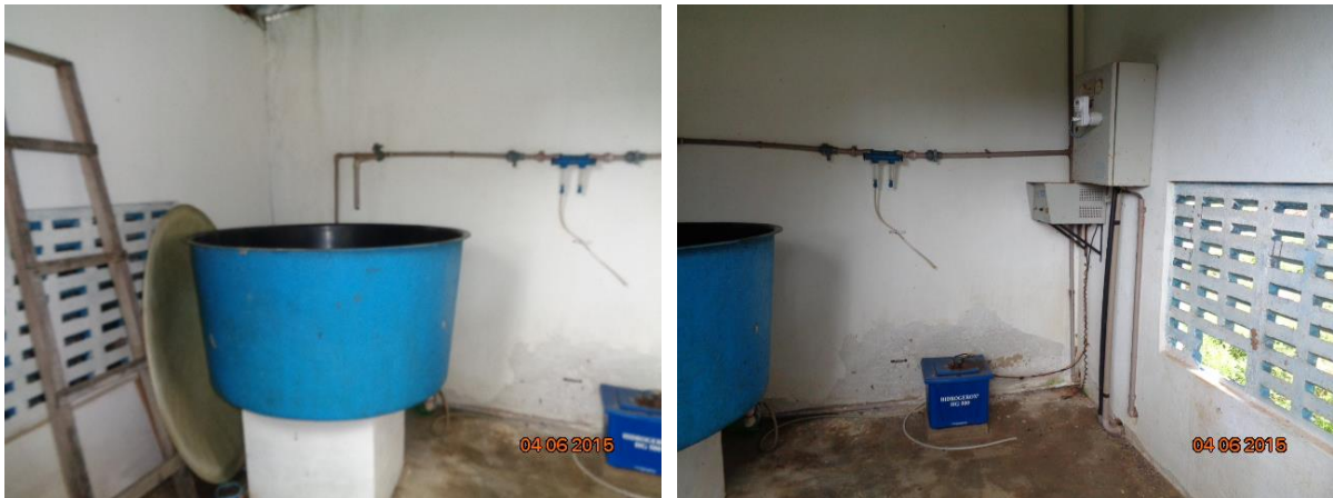
Figura 82 – Casa de química do Poço artesiano – Distrito de Itapeipu
