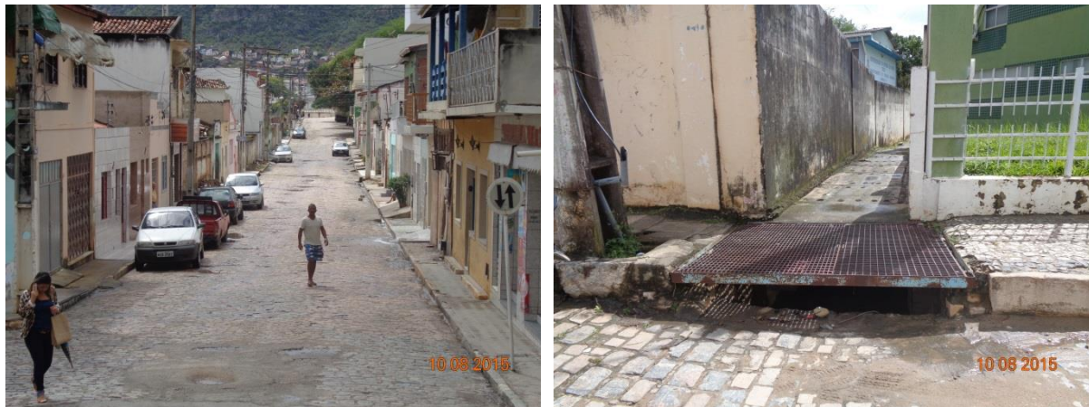
Figura 167 – Áreas com risco de inundação na região entre as ruas Francisco Rocha Pires e Duque de Caxias (à esquerda), e na Rua J. J. Seabra onde existe uma galeria fechada (à direita)
