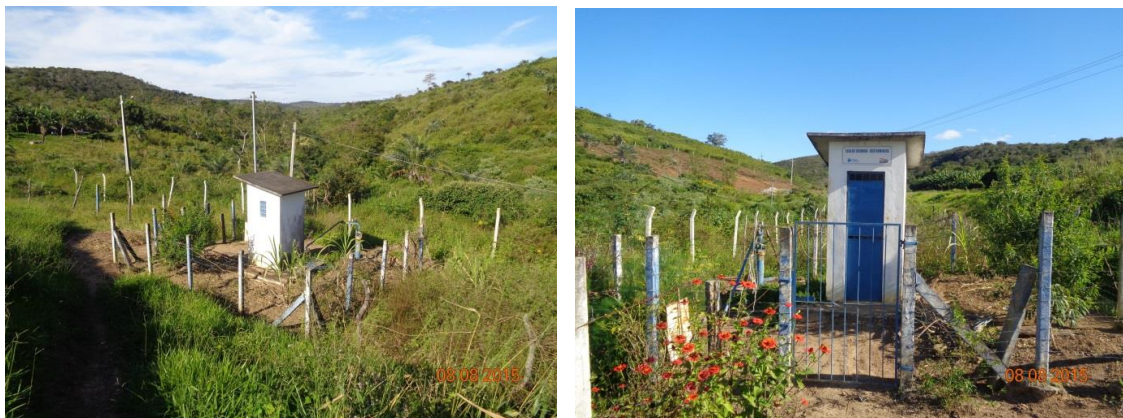
Figura 102 – Poço artesiano no povoado de José Domingos
