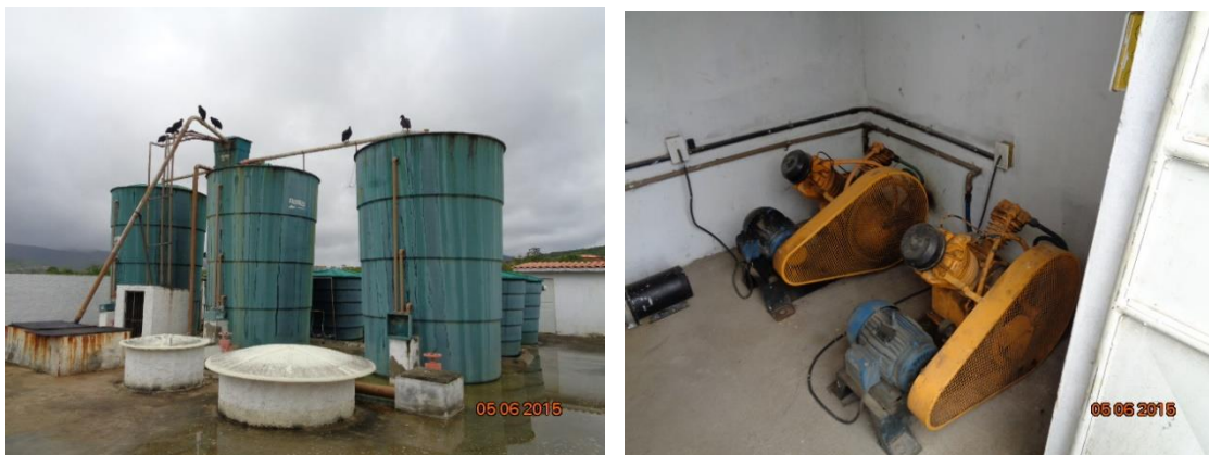
Figura 118 – Tanques de tratamento e Bombas
