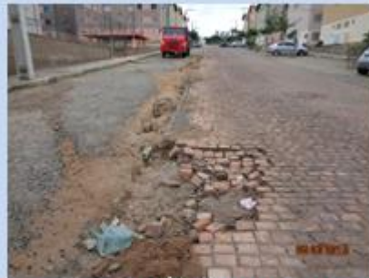
sinais de erosão causada pelo escoamento superficial das águas das chuvas
