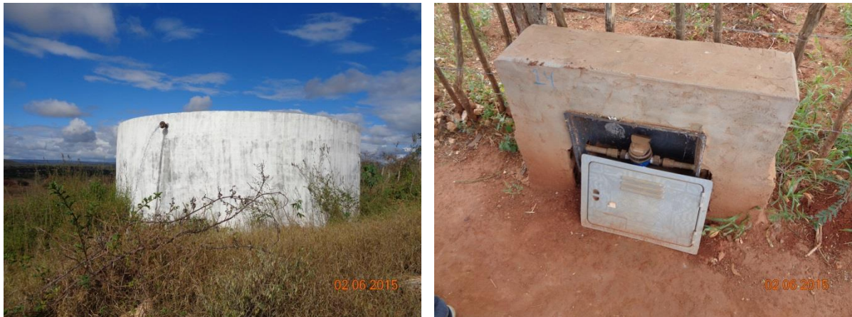
Figura 79 – Reservatório e hidrômetro no Distrito de Caatinga do Moura
