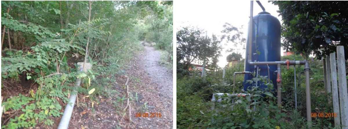
Figura 110 – Rede de adução de água bruta e filtro com clorador
