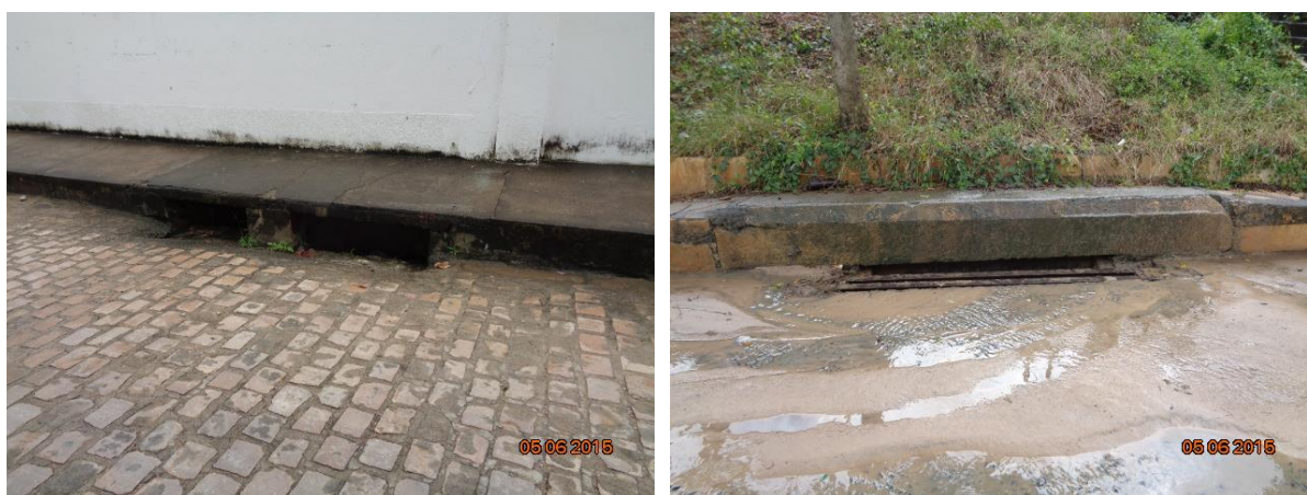
Figura 179 – Bocas de lobo no Bairro dos Índios
