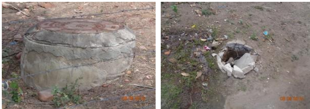
Figura 126 – PV da rede coletora (danificado)
