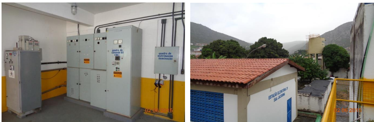
Figura 47 – ETA 1 – Painel de comando e EEAT
