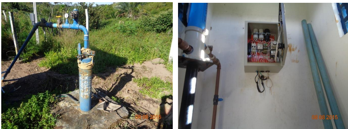
Figura 103 – Poço artesiano no povoado de José Domingos
