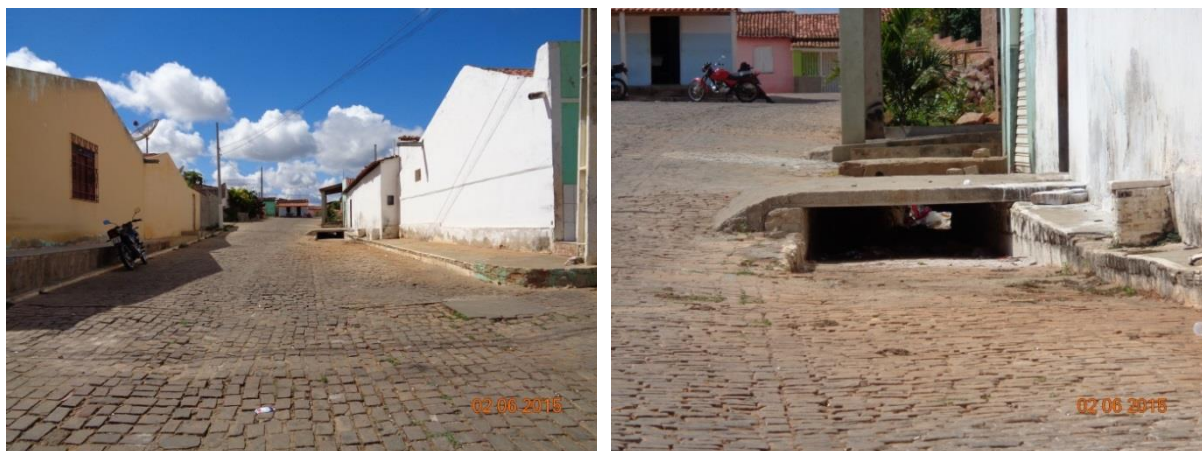
Figura 187 – Sistemas de captação de água pluvial no povoado de Caatinga do Moura
