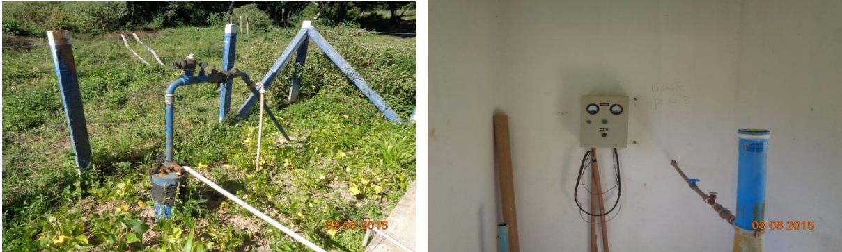
Figura 99 – Poço artesiano e sistema de desinfecção
