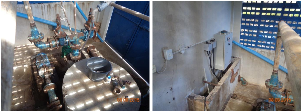
Figura 96 – Interior da casa de máquinas
