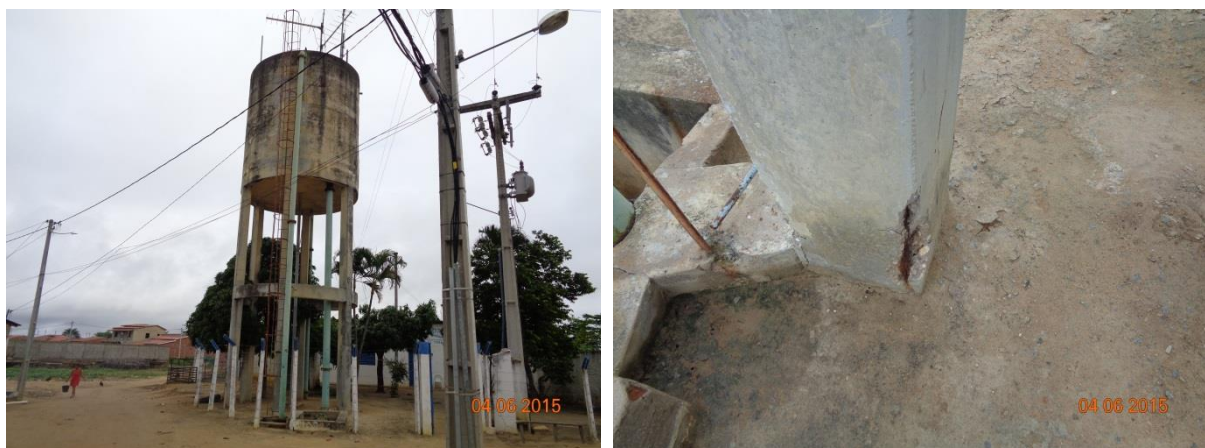
Figura 76 – REL 60 m 3 localizado em Paraíso – base da coluna com ferragem exposta
