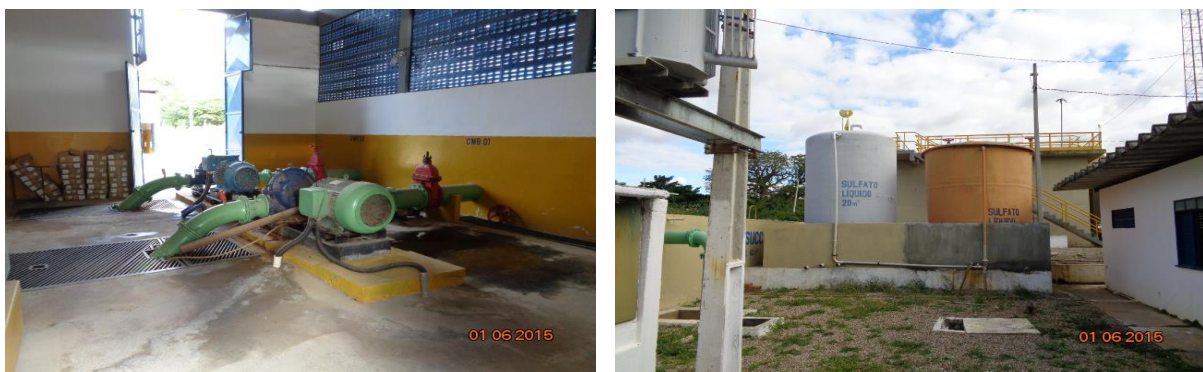
Figura 51 – ETA 2 – Sala de bombas e tanques de produtos químicos
