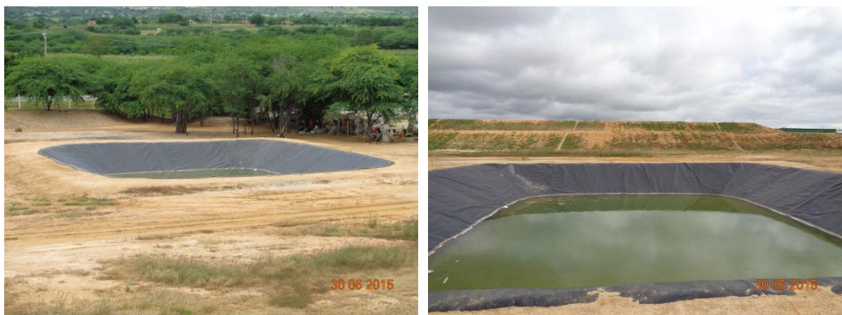
Figura 156 – Lagoa para o futuro tratamento do chorume
