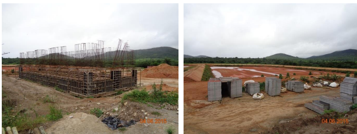
Figura 135 – Obra da ETE paralisada - estruturas e materiais sendo danificados pela exposição ao tempo
