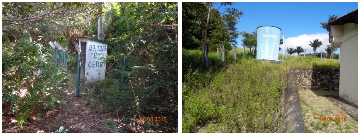
Figura 97 – Poço artesiano e reservatório de 20m 3
