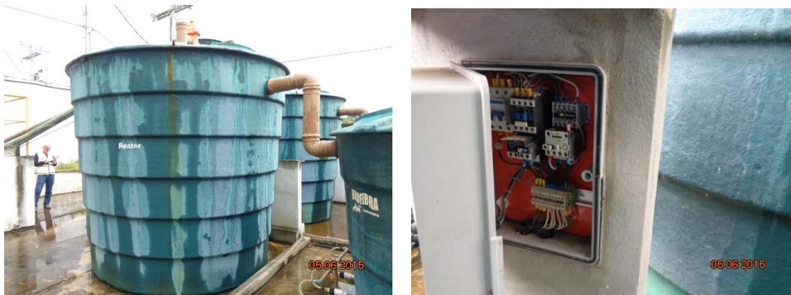
Figura 114 – Tanques e painel de força da ETE
