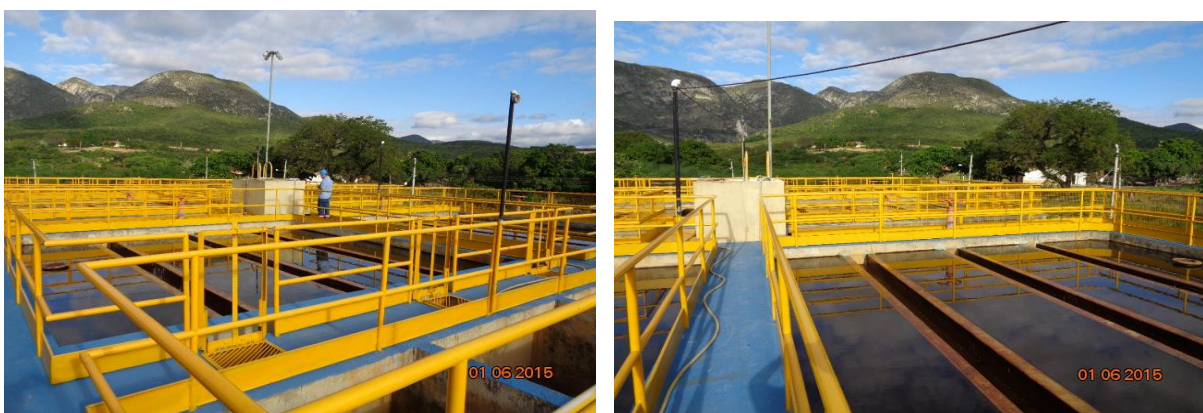
Figura 52 – ETA 2 – unidades de tratamento de água
