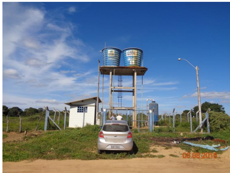
Figura 100 – Local de filtração e reservação de agua tratada
