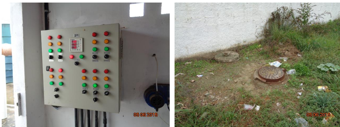
Figura 119 – Painel de comando e PV de saída de efluente tratado
