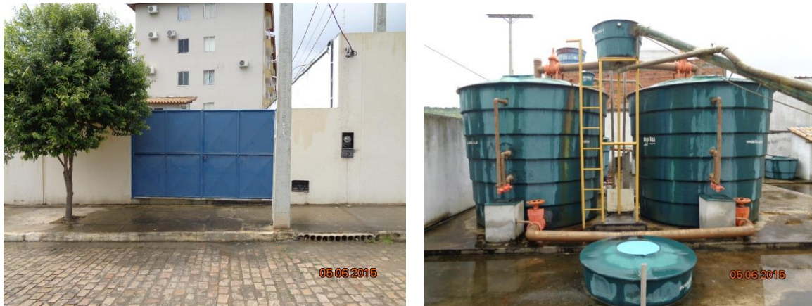
Figura 113 – Portão e Tanques da ETE
