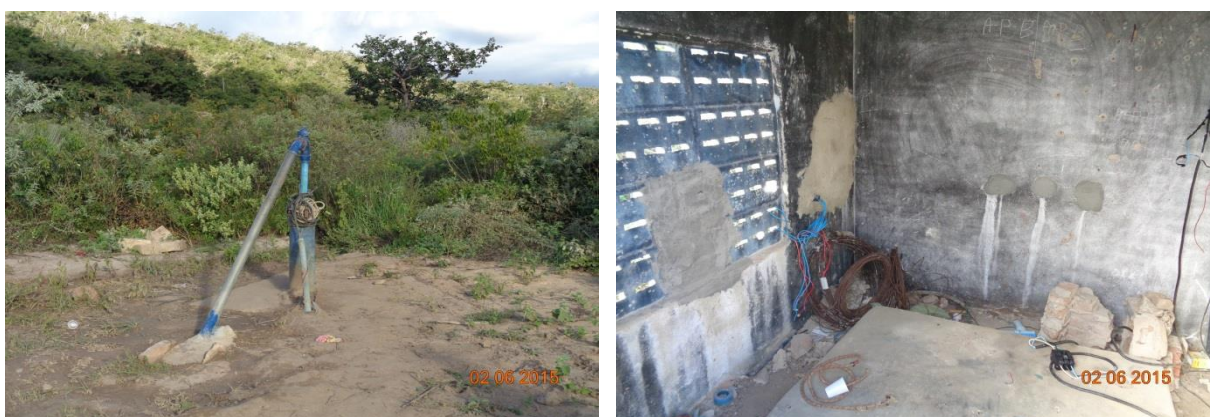
Figura 91 – Poço 1 do SAA de Lajes do Batata
