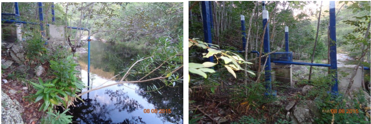
Figura 108 – Captação no riacho e Caixa da bomba
