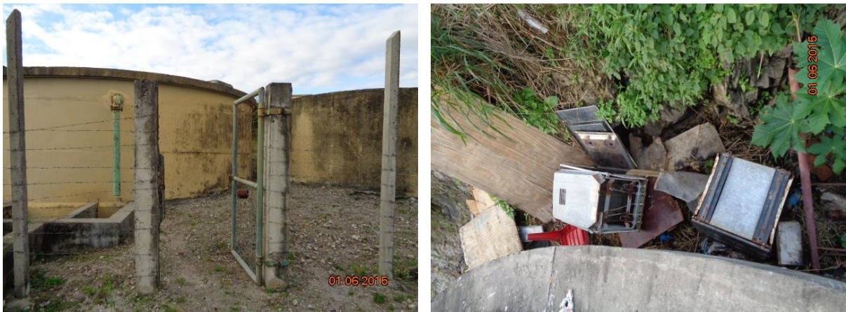
Figura 58 – Acesso livre aos RAP 3 e 5 e lixo ao lado do RAP 1
