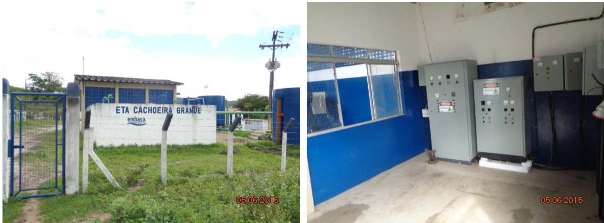
Figura 61 – Entrada da ETA / Painel de comando
