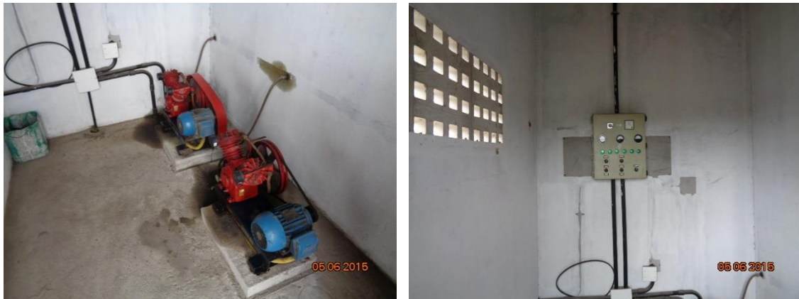
Figura 115 – Bombas e painel de comando
