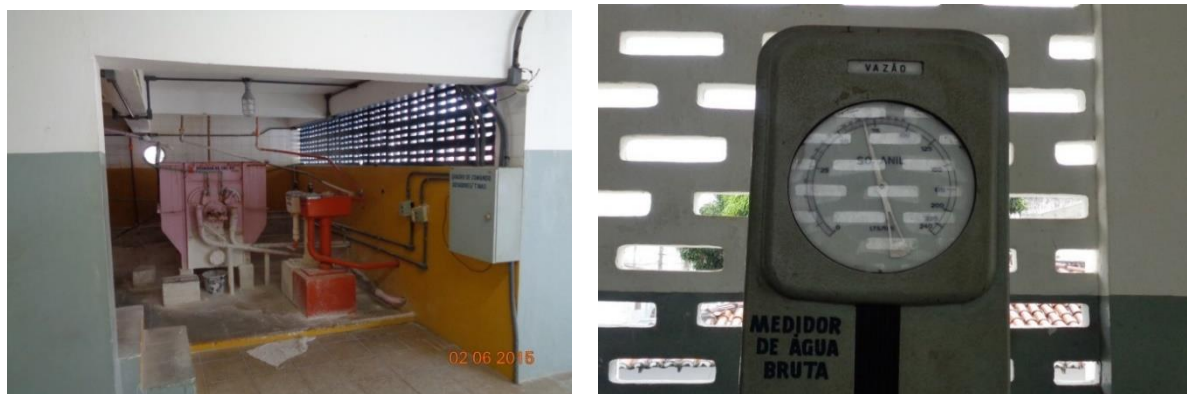
Figura 45 – ETA 1 – dosador de cal e medidor de vazão
