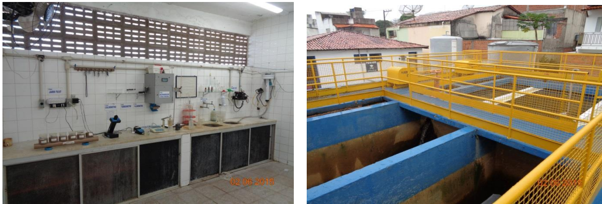
Figura 46 – ETA 1 – Laboratório e unidade de tratamento
