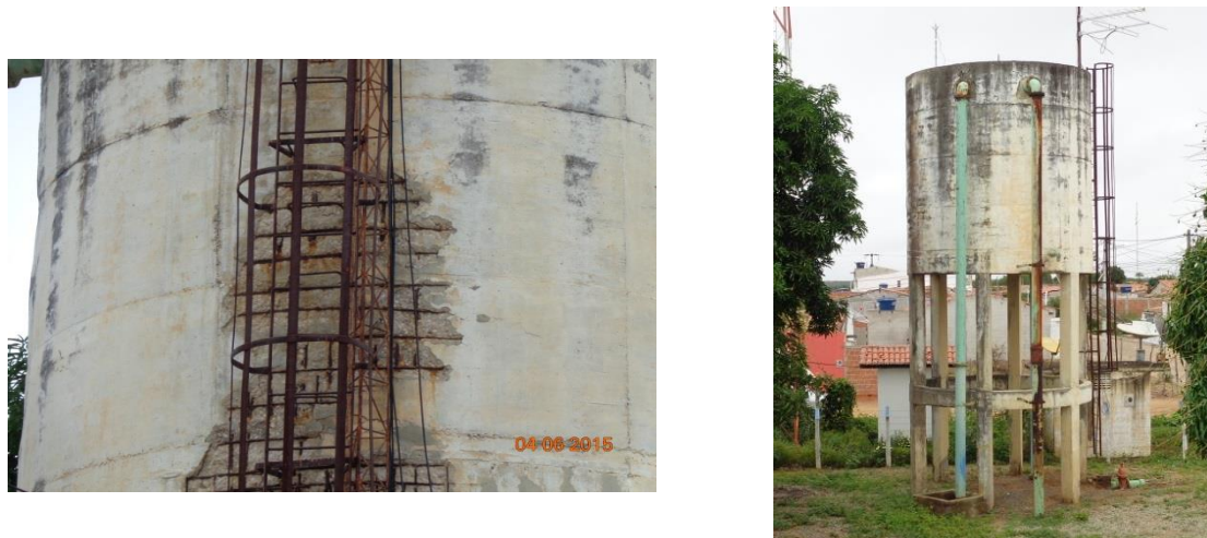
Figura 74 – REL 60 m 3 localizado em Junco – escada danificada
