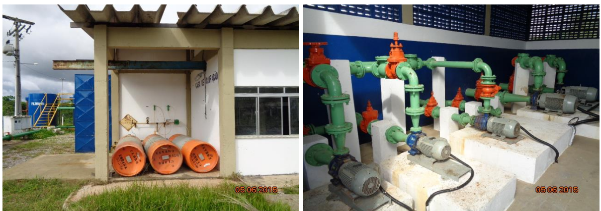
Figura 62 – Cloro gás / Casa de bombas
