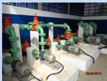
Casa de bombas
