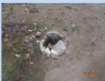
PV da rede coletora (danificado)
