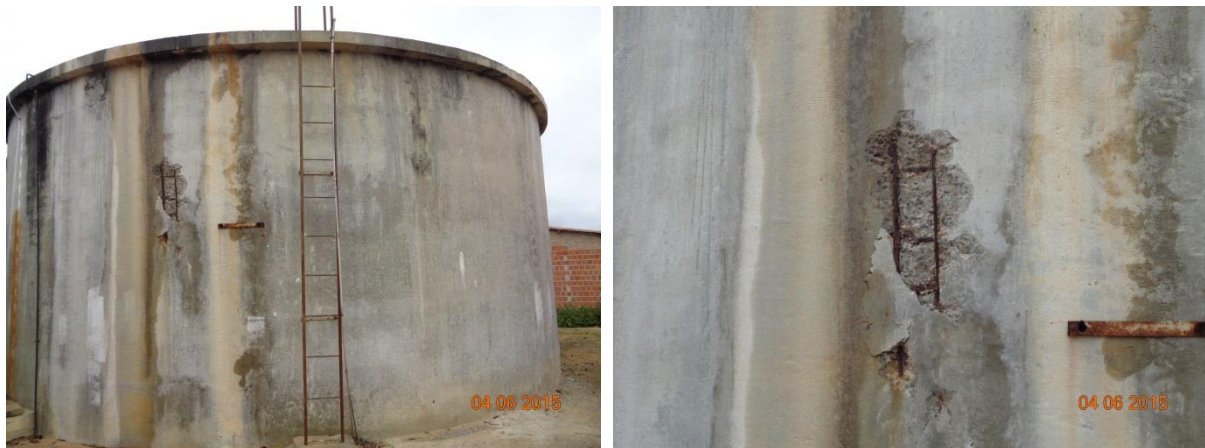
Figura 75 – RAP 300 m 3 localizado em Paraíso com sinais de desgastes
