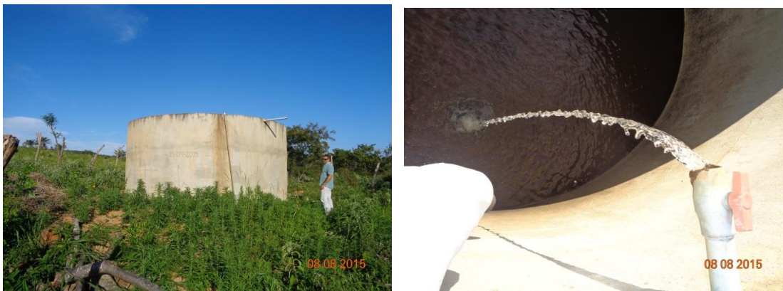
Figura 106 – Reservatório de Barroão de Baixo
