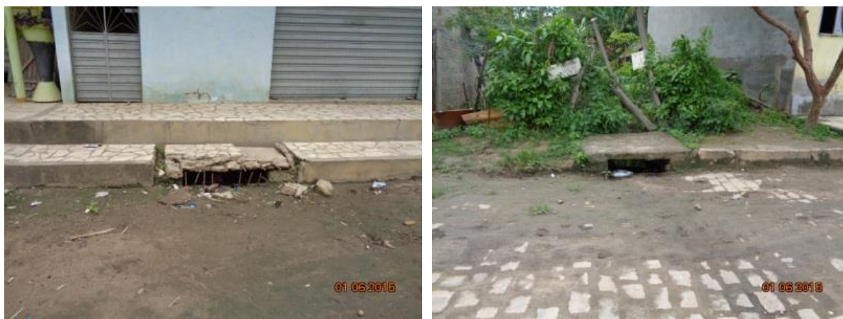
Figura 178 – Bocas de lobo no Bairro Bananeiras
