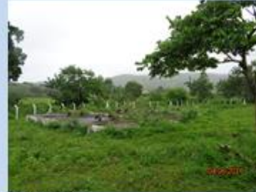
Estrutura da ETE abandonada
