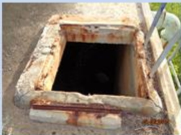
Tampa de inspeção do RAP 6 (morro do Perú) danificada
