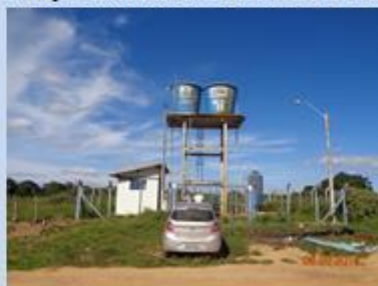
Local de filtração e reservação de água tratada
