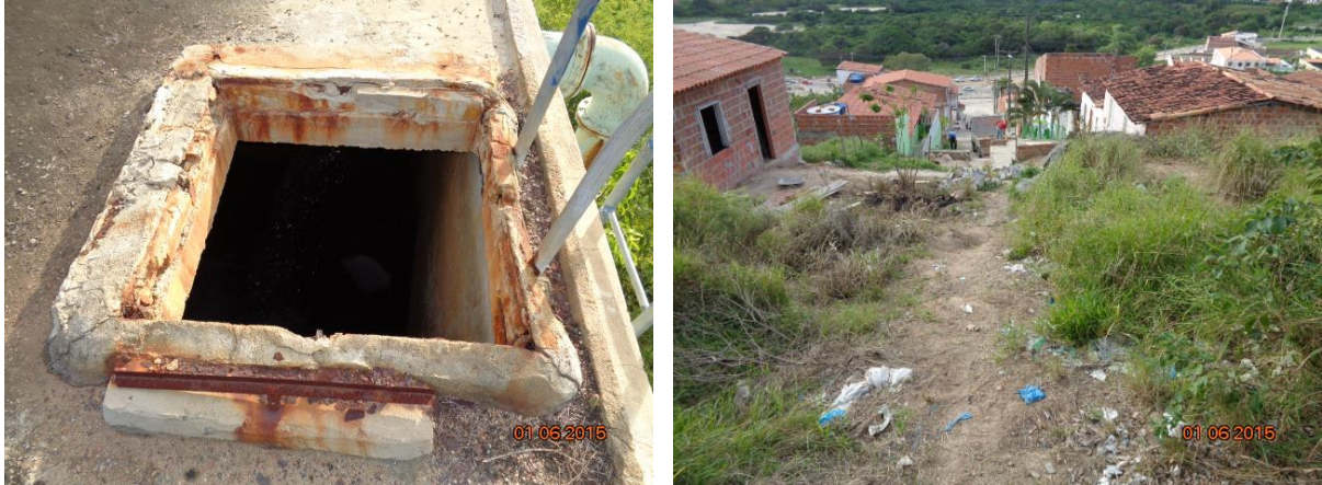
Figura 57 – Tampa de inspeção do RAP 6 (morro do Perú) danificada e vista do acesso ao reservatório
