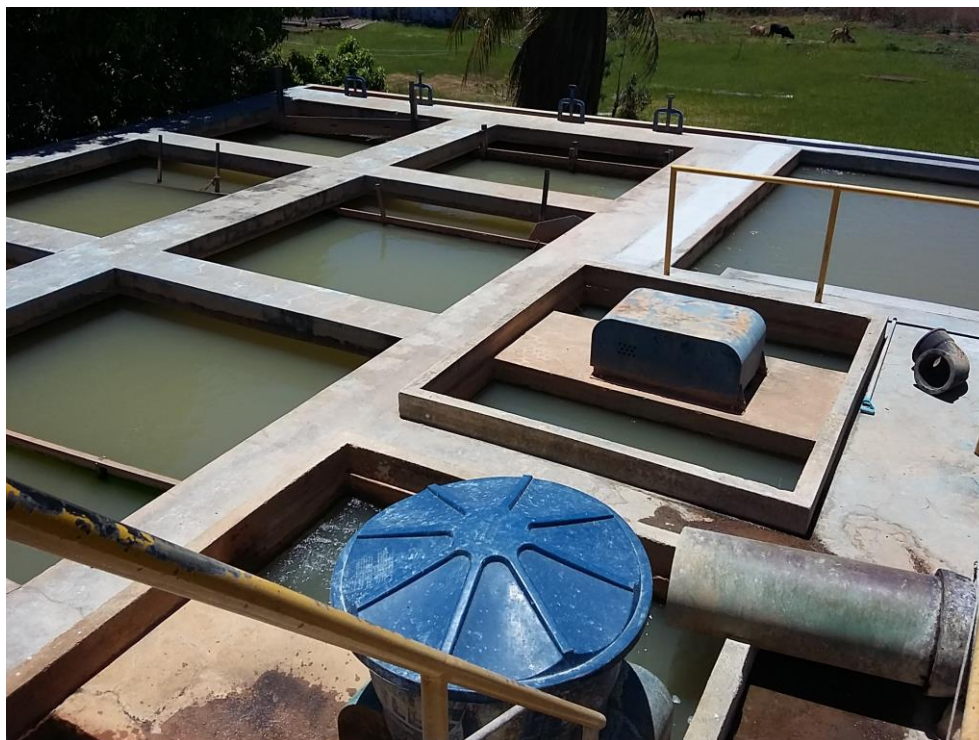
Figura 3.5 – Estação e Tratamento de Água – ETA Remanso
