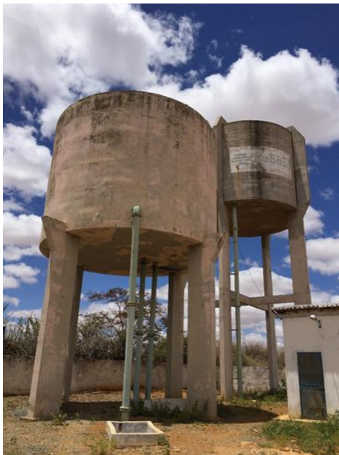
Figura 3.5 – Reservatório de Água em Presidente Dutra.
