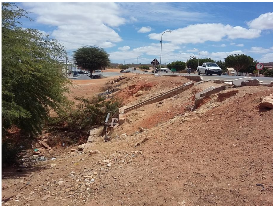
Figura 3-7 – Estruturas do sistema de drenagem em América Dourada.
